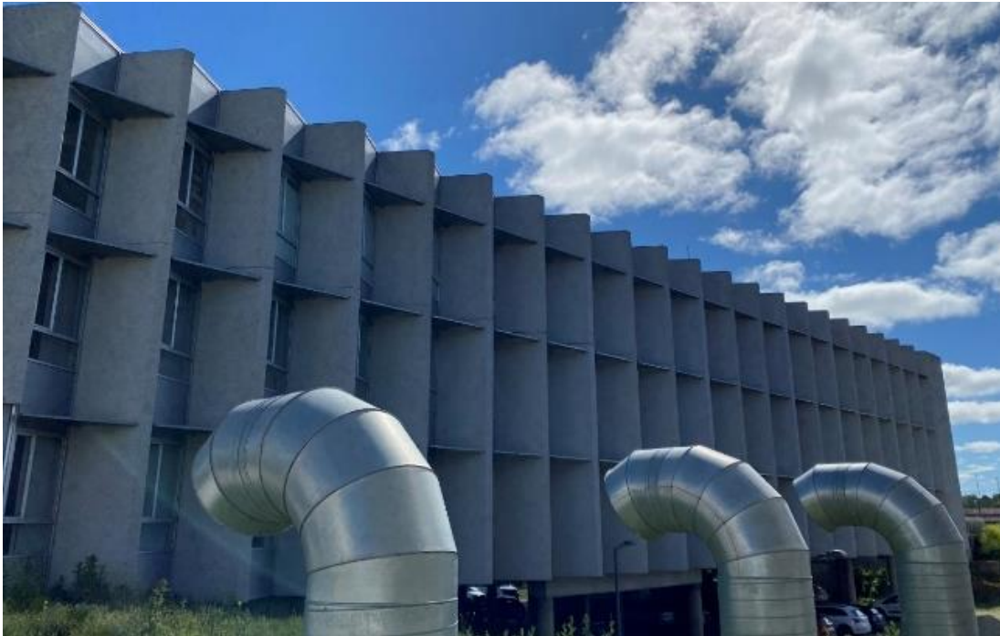
Ilustración 28. Tomas de aire sistema de geotermia.
