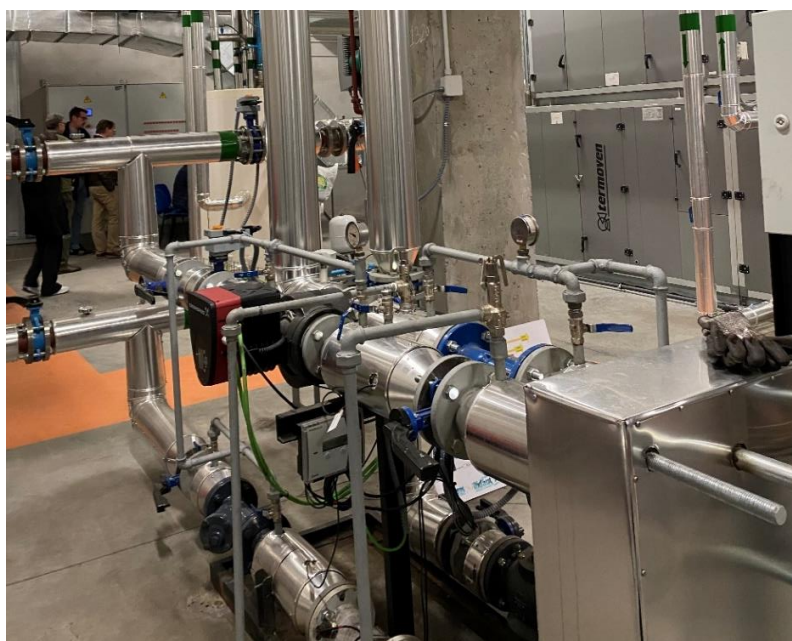
Ilustración 24. Subestación edificio LUCIA
