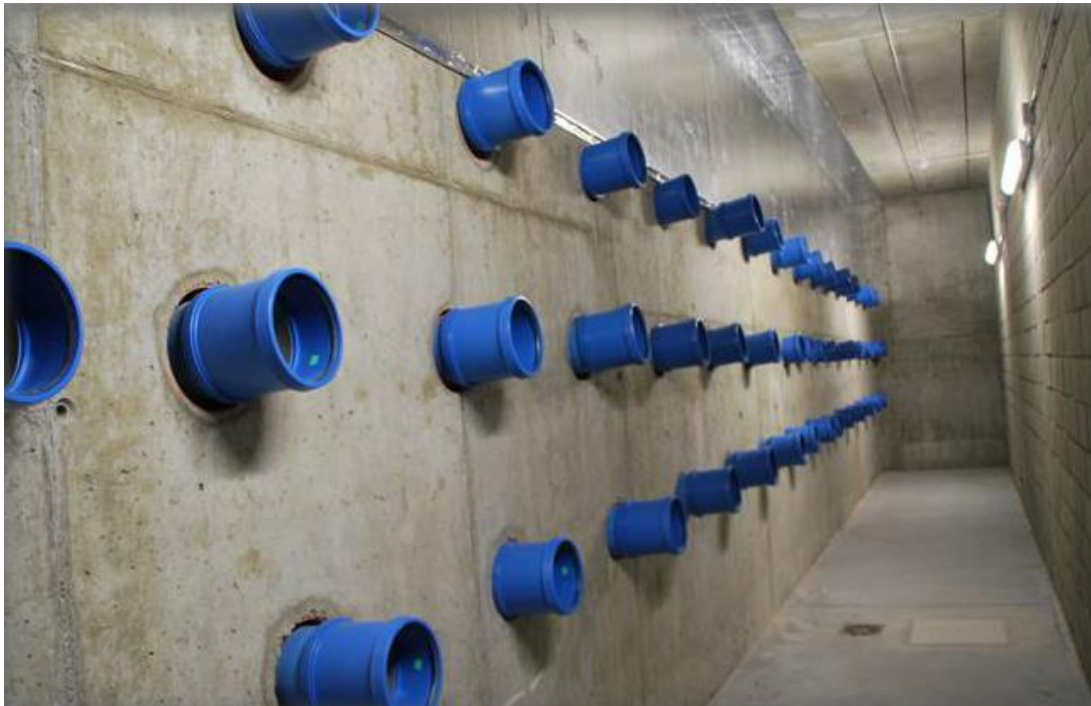
Ilustración 30. Salida tubos geotérmicos.
