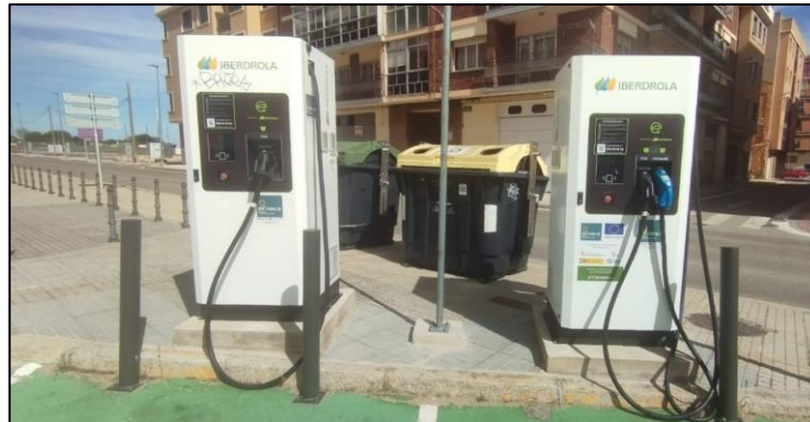
Ilustración 36. Postes eléctricos Calle San Francisco, 42 (Aranda de Duero). Fuente: Electromaps
