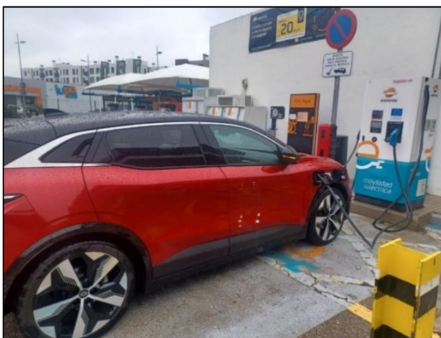
Ilustración 28. Punto de recarga Repsol Aranda de Duero. Fuente: Electromaps
