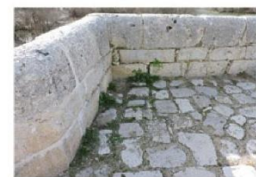
MAL DRENAJE DEL AGUA
