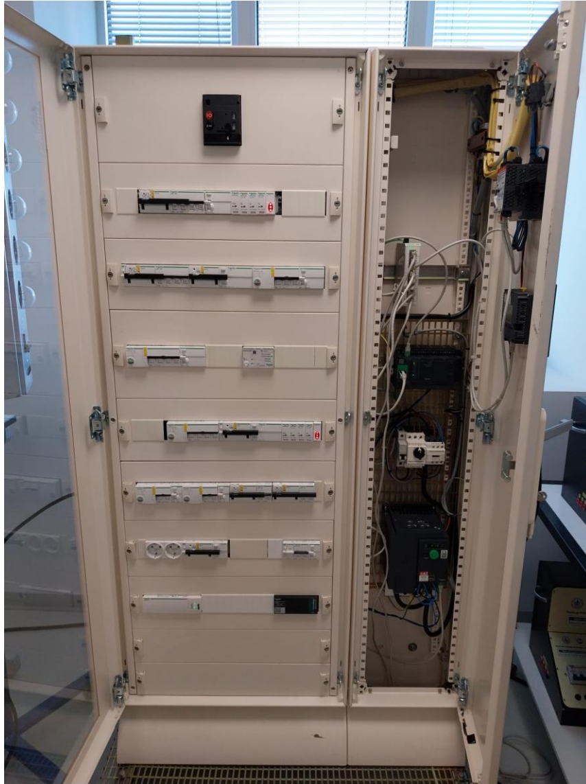
Ilustración 36: Cuadro eléctrico Real, puertas abiertas (fuente: [elaboración propia])
