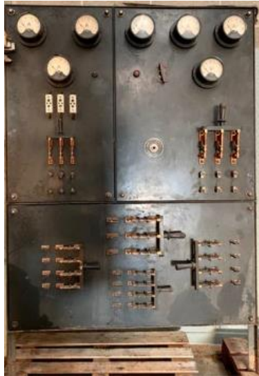
Ilustración 4: Cuadro eléctrico antiguo
