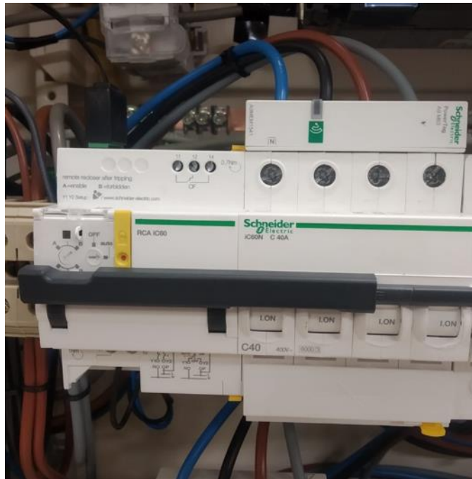
Ilustración 43: Reconector RCA instalación real (fuente: [elaboración propia])
