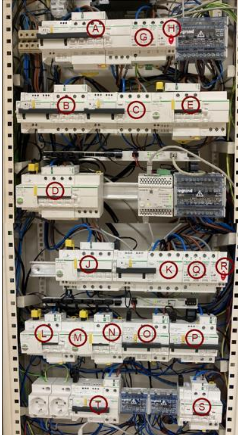
Ilustración 75: Interior del armario eléctrico
