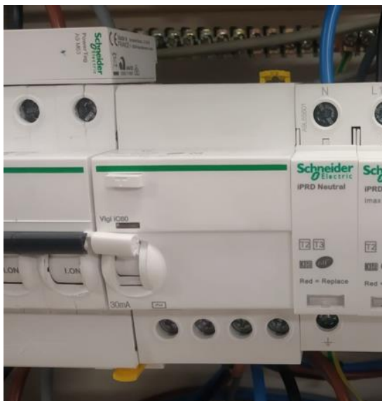
Ilustración 40: Interruptor diferencial Vigi (fuente: [elaboración propia])
