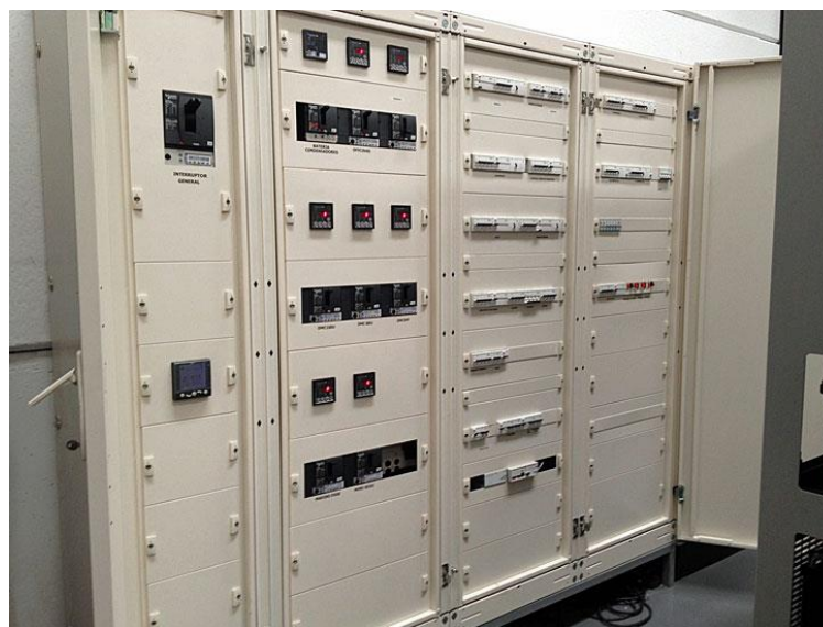
Ilustración 8: Cuadro eléctrico inteligente, vista interior (fuente: [26])
