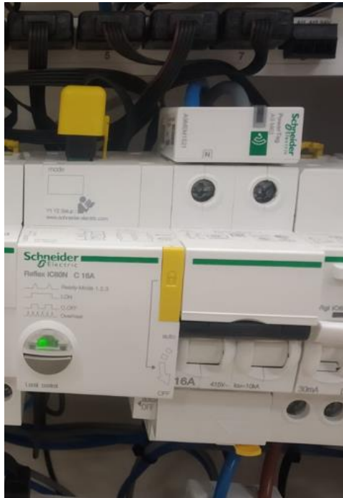
Ilustración 42: Reflex Instalación real (fuente: [elaboración propia])
