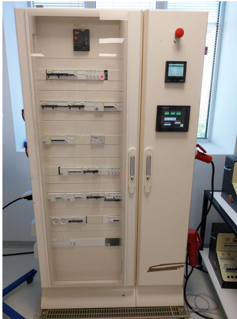
Ilustración 35: Cuadro eléctrico real, puertas cerradas (fuente: [elaboración propia])
