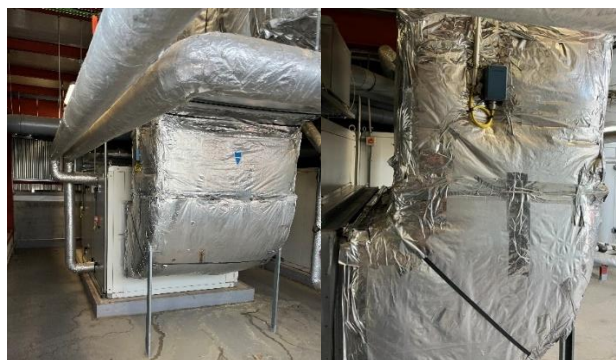
Figura 48. Conductos de ventilación
