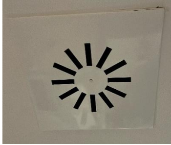
Figura 10. Difusor rotacional impulsión sala de tallado
