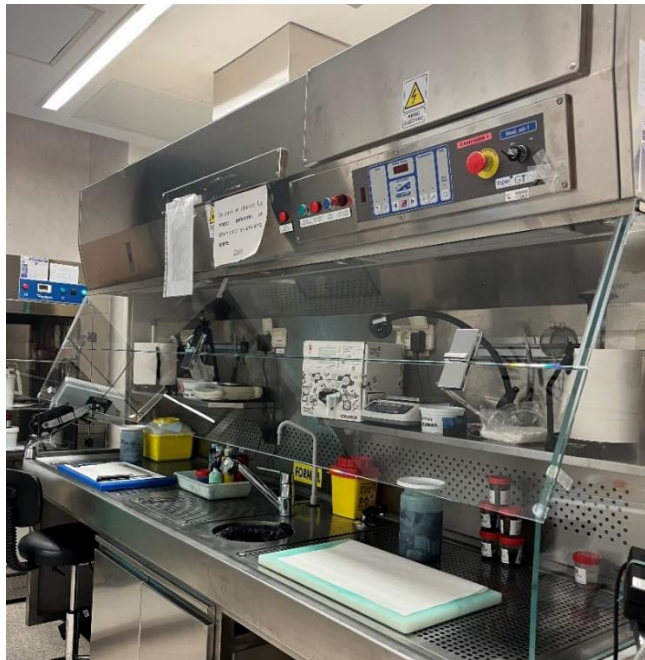
Figura 8. Campana de extracción de gases de Sala de tallado
