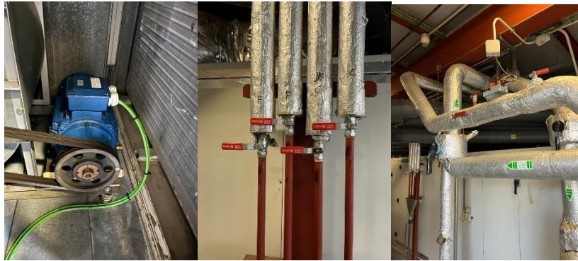
Figura 46. Ventilador de impulsión, válvulas de calor y batería
