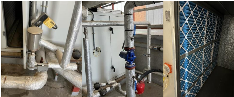
Figura 47. Humectador, válvula de frío y sistema de filtrado
