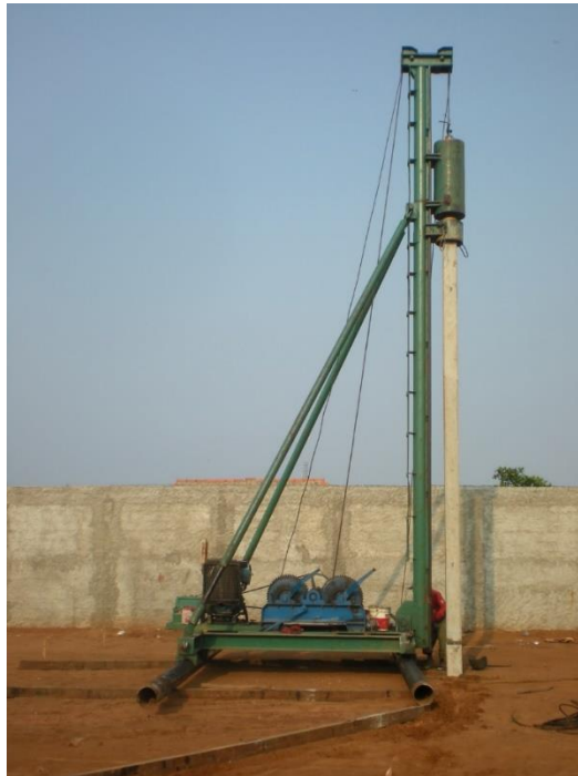
Ilustración 36: Máquina para hincas de pilotes. (Lindley, 2024)
