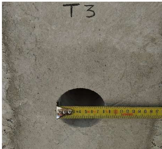
Figura A3. Medición de la sección de la cavidad de un testigo de hormigón de 75 mm
