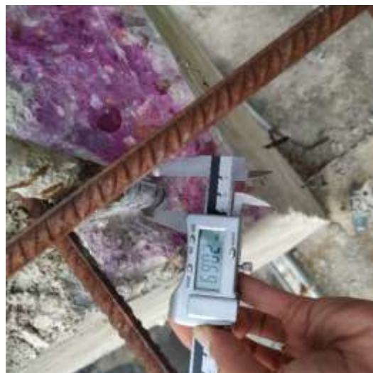
Figura A1. Comprobación de la sección de una armadura en elemento estructural
