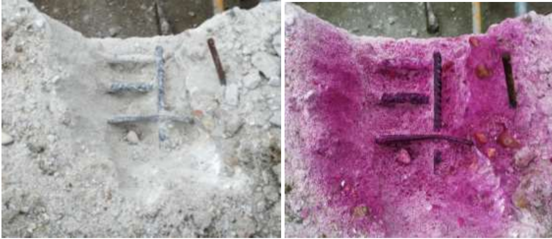
Figura A9. CATA 5. Antes y después del ensayo
