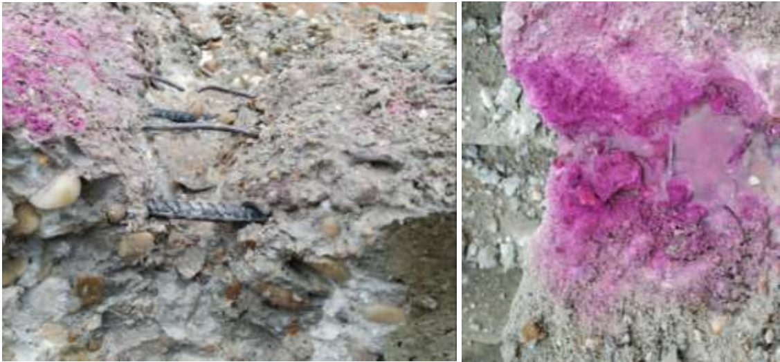
Figura A10. CATA 6. Antes y después del ensayo
