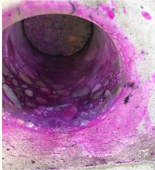
Figura A2. Comprobación del estado de la cavidad de un testigo mediante carbonatación
