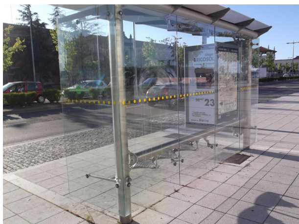
Figura 5.10.- Señalización incorrecta de cerramiento de vidrio de marquesina, Valladolid
