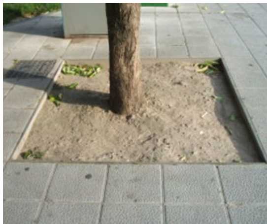
Figura 5.21.- Alcorque no enrasado próximo a parada de taxi, Valladolid
