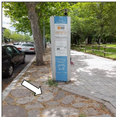
Figura 6.8.- Pavimento inadecuado en parada de autobús, Segovia
