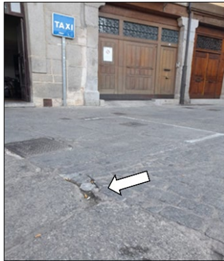
Figura 6.19.- Parada de Taxi con pavimento inadecuado, Segovia
