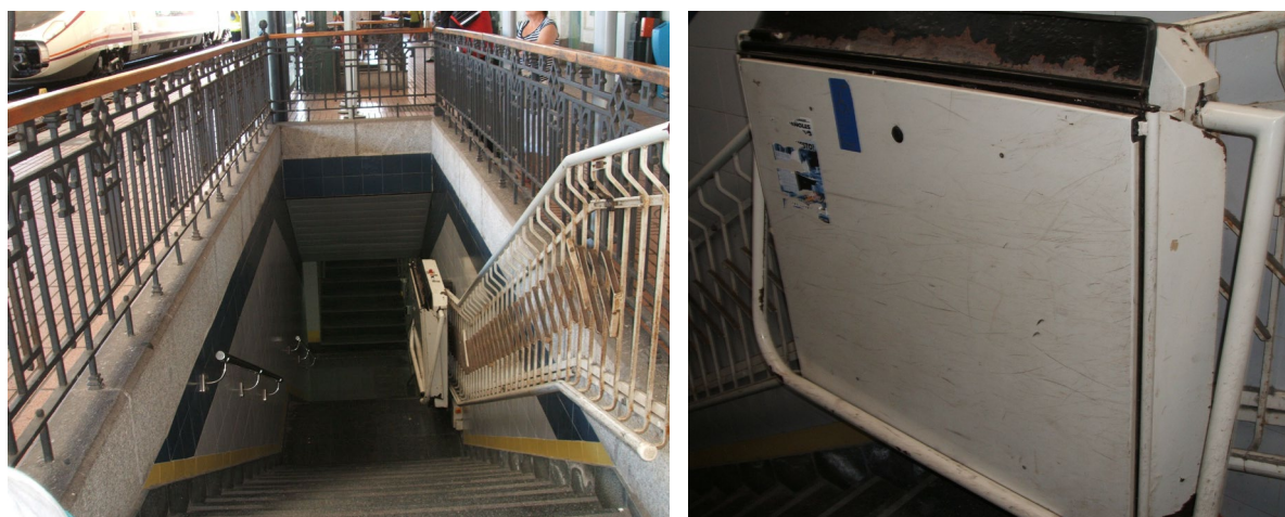
Figura 4.24.- Dispositivo salvaescaleras en estación de tren
