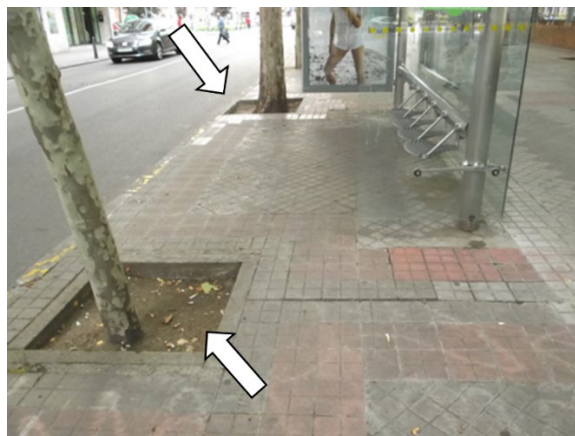
Figura 5.12.- Parada de autobús con alcorques no enrasados al pavimento, Valladolid
