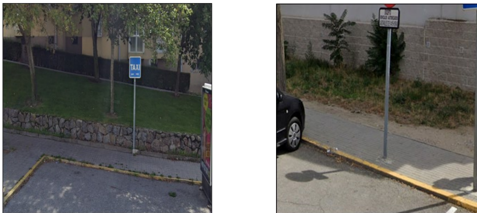
Figura 6.20.- Paradas de Taxi con anchura de acera no suficiente, Segovia
