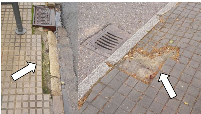
Figura 4.5.- Pavimento en mal estado en itinerario peatonal
