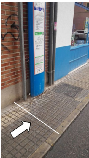
Figura 4.6.- Anchura de acera insuficiente
