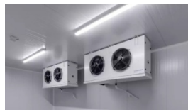
Ilustración 77. Evaporadores en el interior de una cámara
