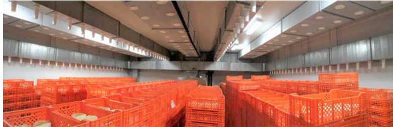
Ilustración36. Vista general de los espacios entre cajas, para refrigeración Fuente: www.camarasfrigorificas.es
