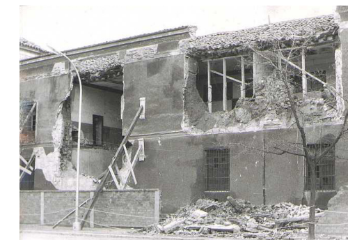
Fig. 73. Estado de abandono y derrumbamiento de la fachada del Archivo de la Real Chancillería de Valladolid, 1970. Obtenida de https://www.diariodevalladolid.es
