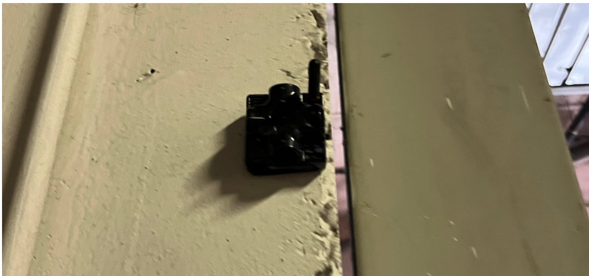
Figura 36. Orientación de las balizas sobre las paredes del aparcamiento.
