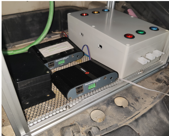
Figura 3.12: Disposición final de los elementos en el rack
