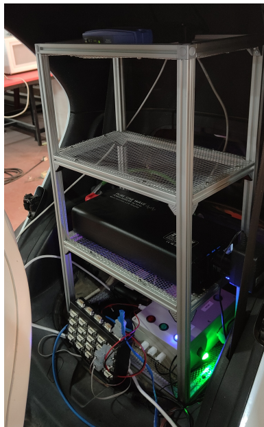
Figura 3.13: Estado final del rack junto con el router y el inversor
