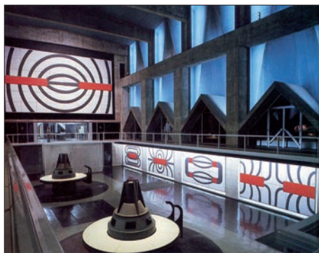
Fig. 13. Joaquín Vaquero, sala de máquinas de la Central eléctrica de Proaza (Asturias), 1964-1968. Foto: Hidroeléctrica del Cantábrico
