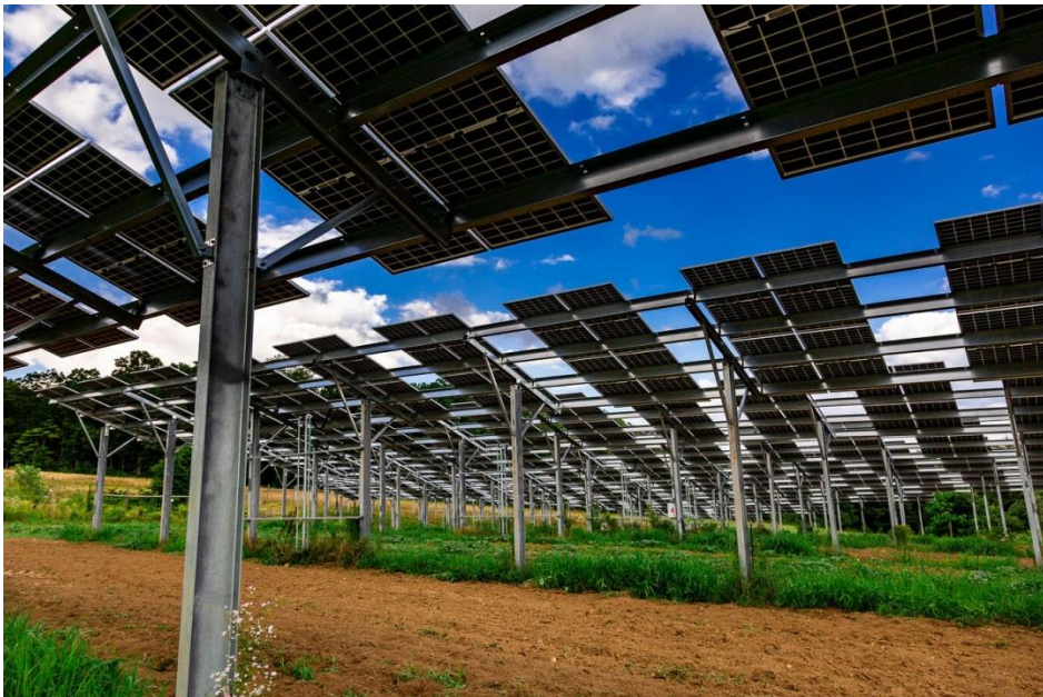
Figura 3.- Instalación sobre marquesina para uso agrícola.
