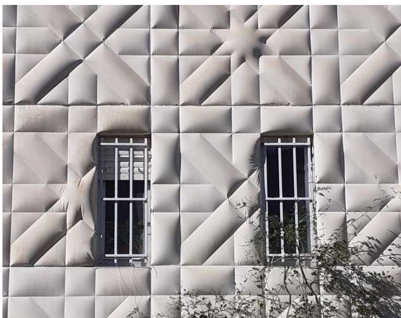
Fig. 55: Fisac. Nuestra Señora de Altamira (Madrid), detalle de los fraguados en encofrados plásticos, en el hormigón se aprecian las arrugas de los moldes dando un aspecto blando y acolchado al edificio, evoca a los castillos inflables para disfrute de los niños. Fotografía de autora.
