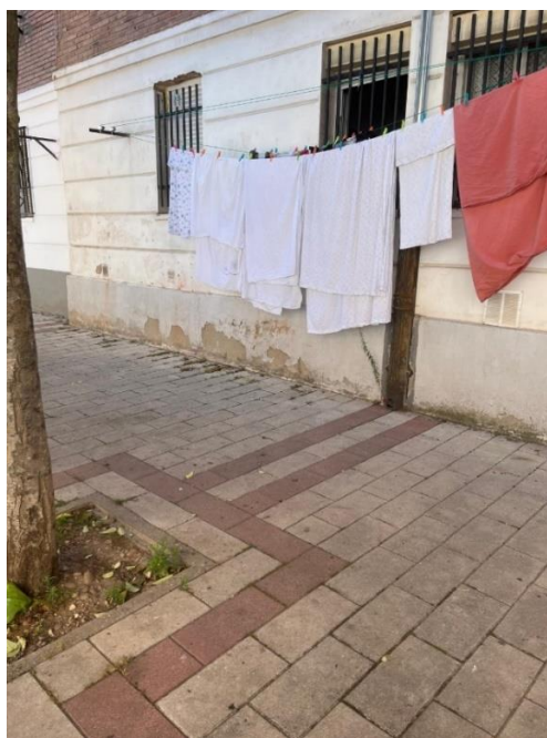
Figura 14. Deterioro de la parte inferior de los bloques de viviendas. Fotografía propia.
