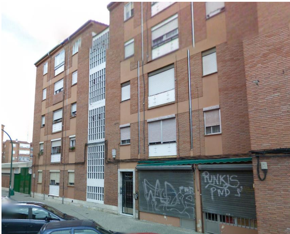
Figura 20. Edificio de la Calle Pinzones, 4 antes de la rehabilitación. Fuente: Google Street View (septiembre de 2008).
