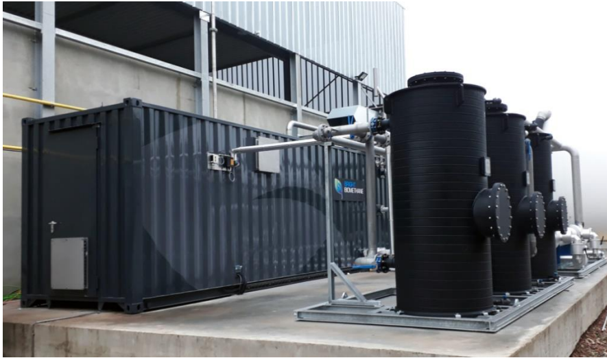
Imagen 6. Unidad de upgrading contenerizada
