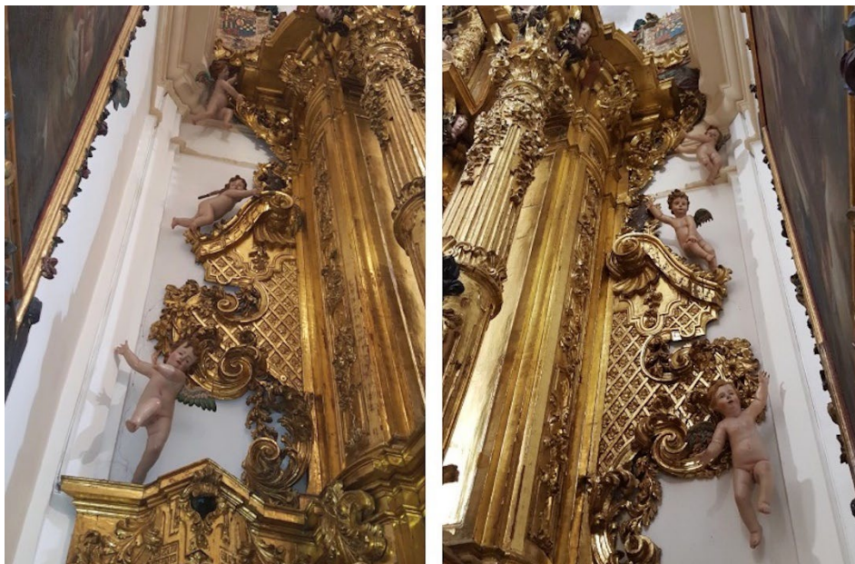
Fig. 13. Cerramientos laterales con aletones decorativos (detalle de la fig. 2). Foto: F. J. Aranda
