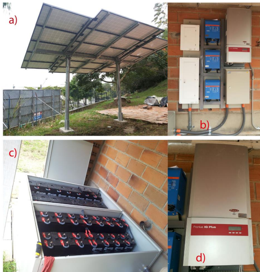
Figura 4.2. Sistema de captación solar fotovoltaica
