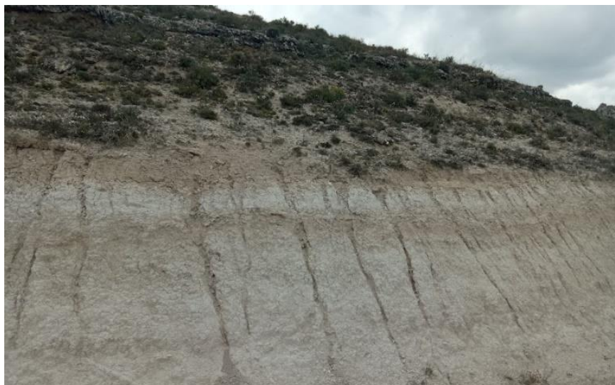
Imagen 9: Líneas de marcada erosión en regueros (20/05/2023)
