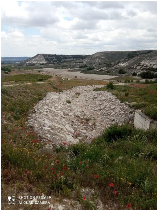
Ilustración 1: Canal de desagüe
