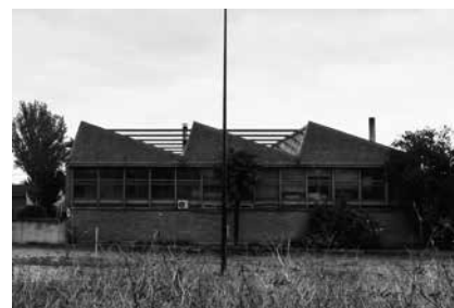
Fig. 7 Nave de Tableros Aislantes. Fotografía de la fachada oeste (desde Ctra. Overuela)
