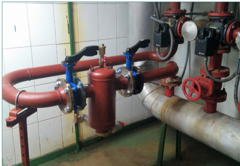
Fig 3. Bombas y filtros que fueron necesario reponer para solucionar la avería en el circuito de impulsión de la Sala de calderas de la Facultad de Químicas.
