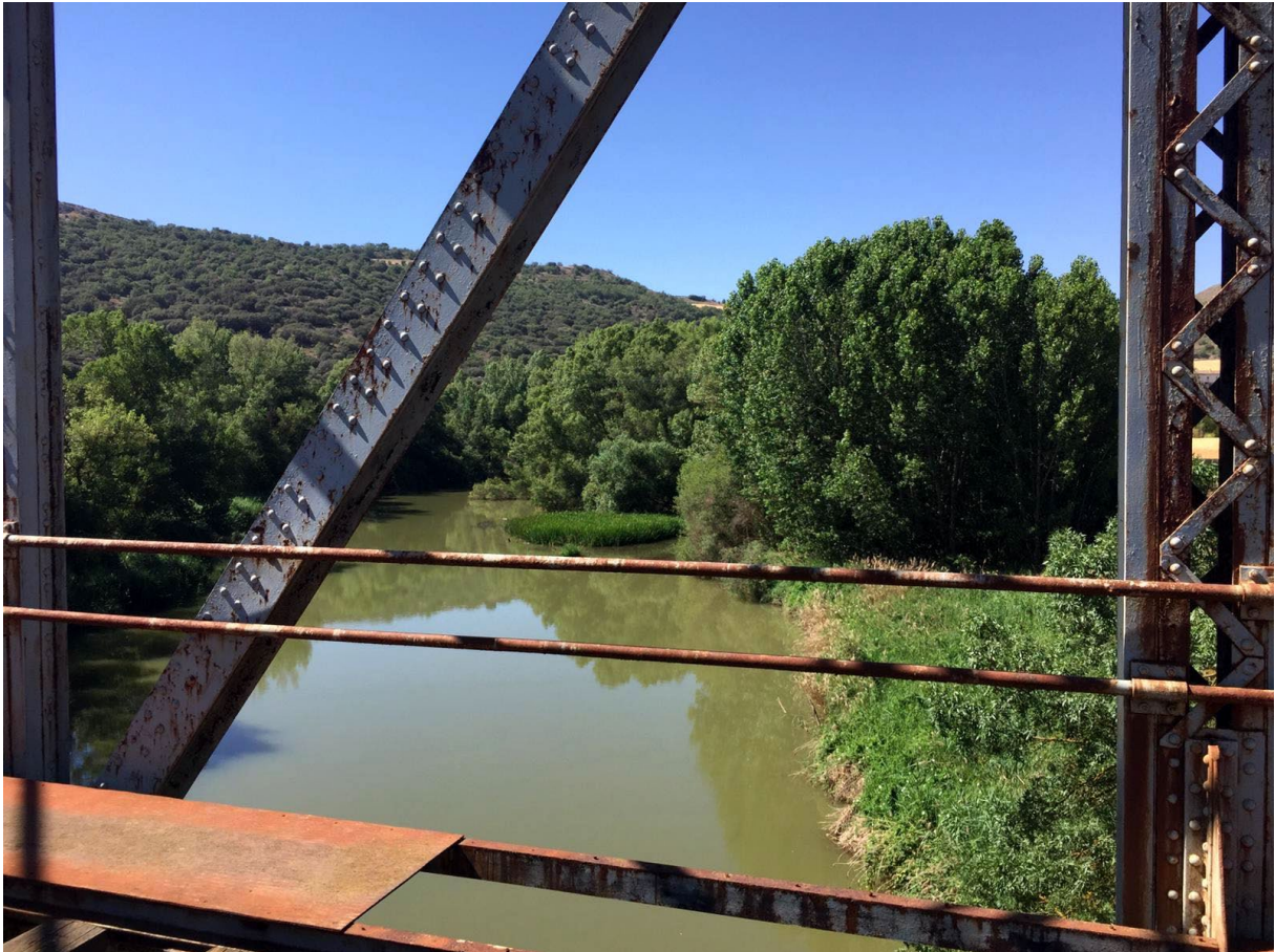
Péndola y barra diagonal del puente de El Empecinado. El andén de tránsito peatonal ha perdido la plancha y ya no permite el paso de personas.
