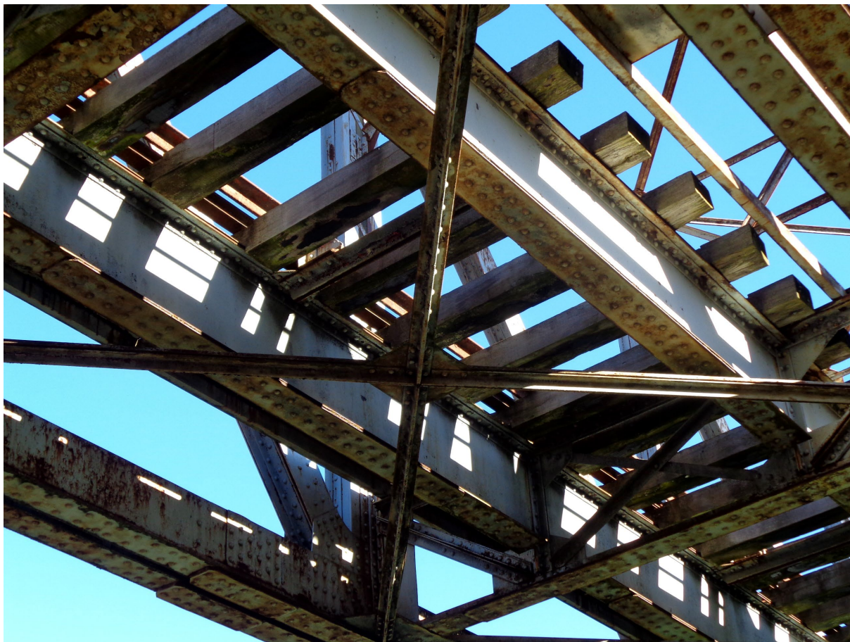
Vigas de soporte de los carriles y arriostramiento inferior del puente de El Empecinado.
