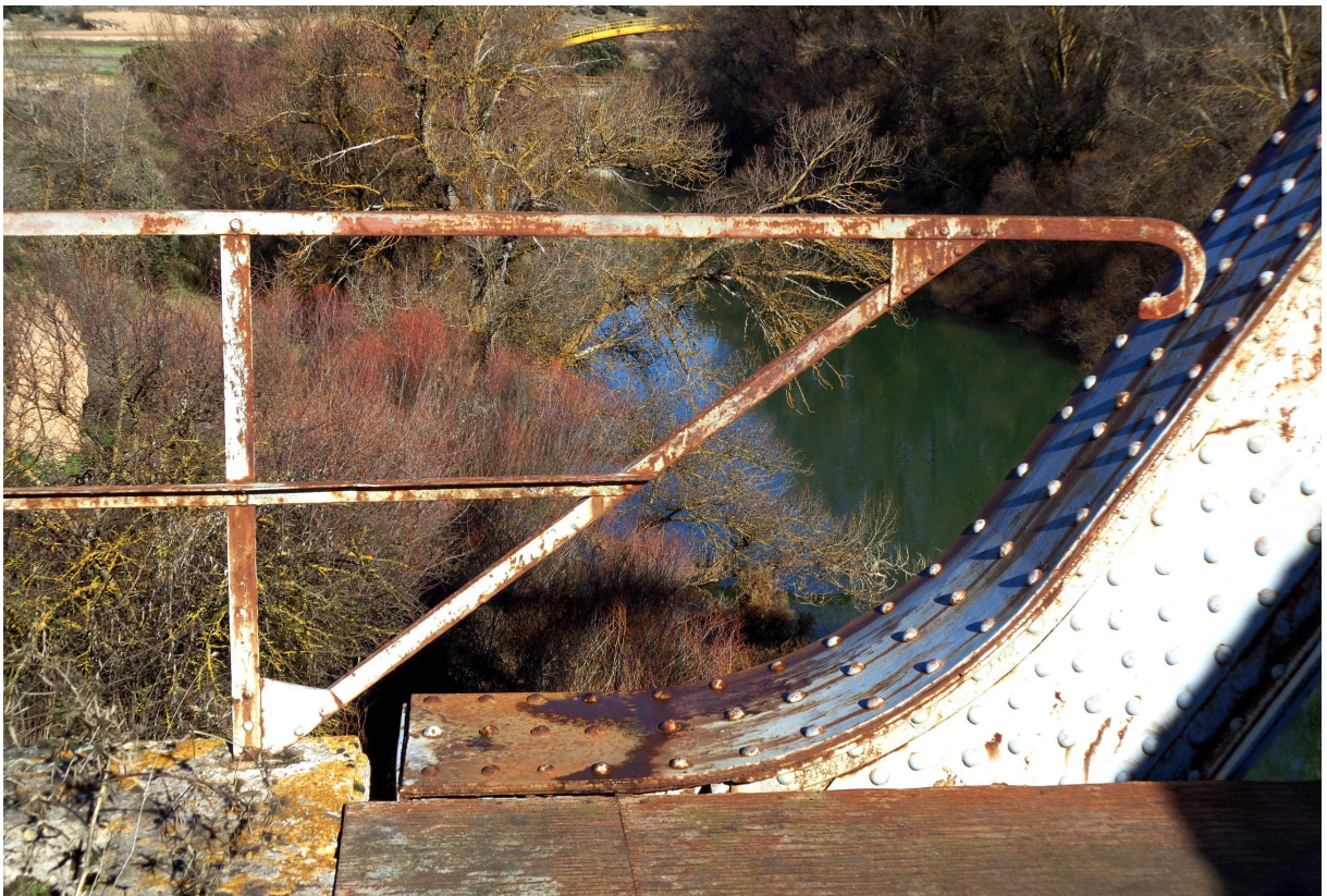
Barandilla de la pasarela de peatones del puente de El Empecinado. Al fondo, otro puente obsoleto: el del Canal del Riaza.
