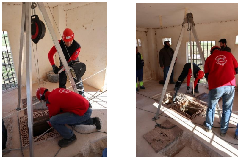
Figura 128. Polea de descenso/ascenso (izquierda) y estructura de trabajo (derecha).
