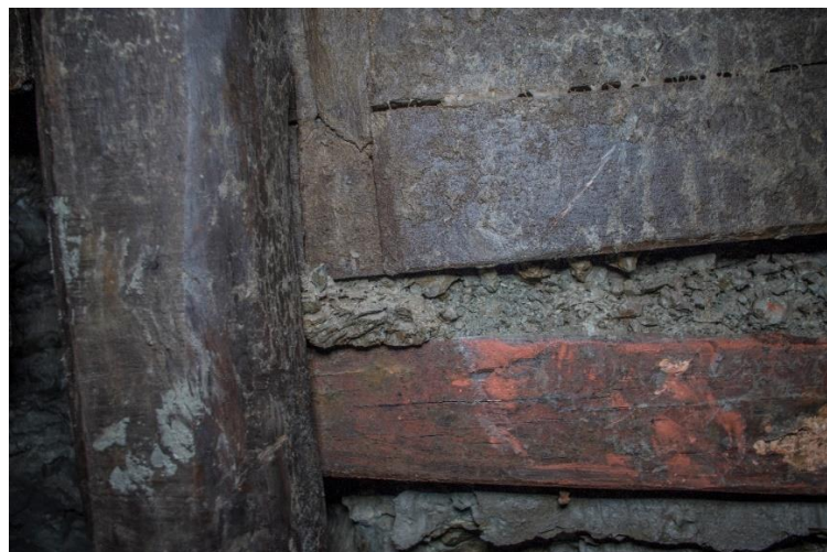
Figura 102. Estado de conservación de las estructuras (Galería 2).
