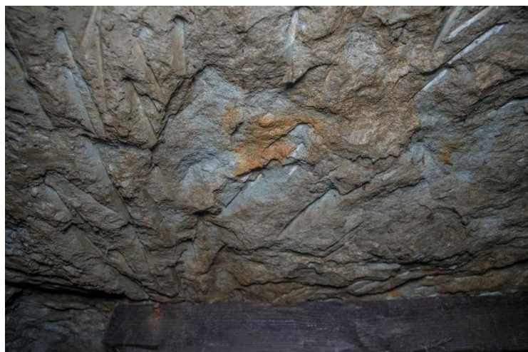
Figura 103. Marcas de pico en el techo de la Galería 2.
