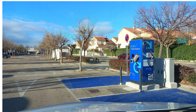
Figura 69: Cargadores de Vehículos Eléctricos en Cascante. [Elaboración propia]
