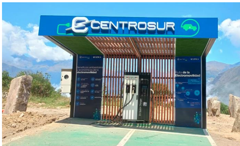
Figura 36. Estación de carga construida e instalada en Cuenca
