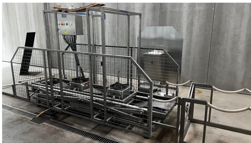
Figura 2.10 – Tren para el lavado de barricas.
