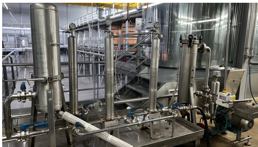
Figura 2.11 – Filtro tangencial con cartuchos utilizado previamente al embotellado.
