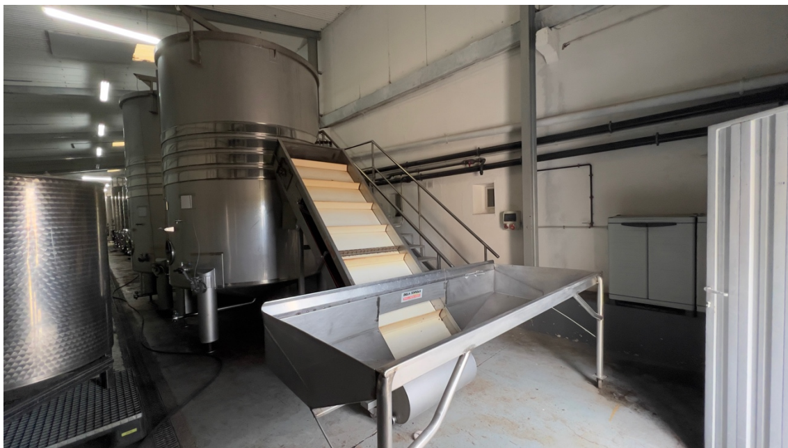
Figura 4.7 – Tolva de recepción y cinta elevadora.
