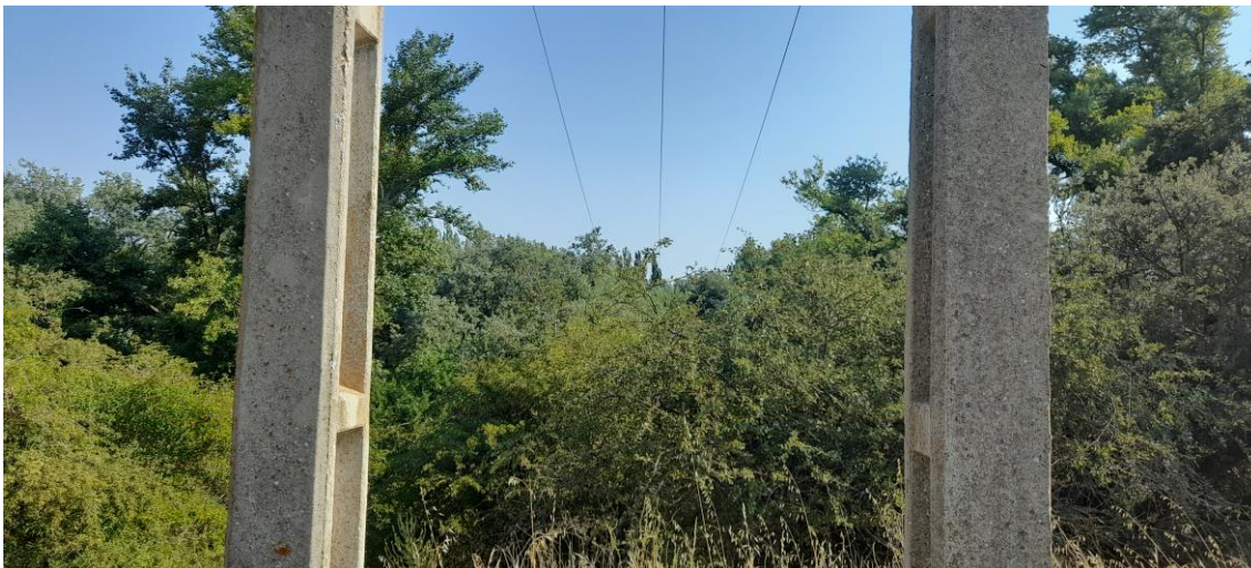
Imagen 22. Obra 7, lado norte chopos en contacto con conductores.
