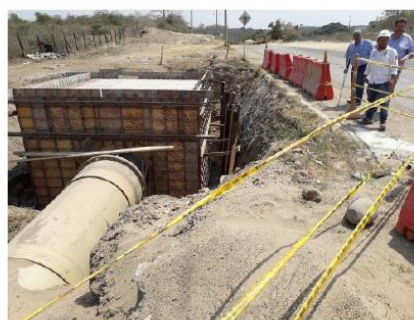
Foto 2: Redes de impulsión de la PTAP
