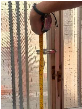
Figura 156 Puerta P2B itinerario 2. Detalle manilla.
