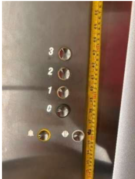
Figura 183 Ascensor botonera interior.
