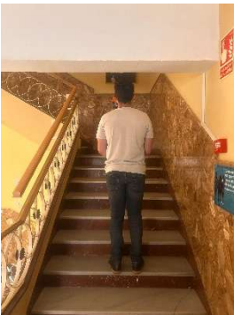
Figura 202 Escaleras 2. Viga que invade altura mín. de paso.
