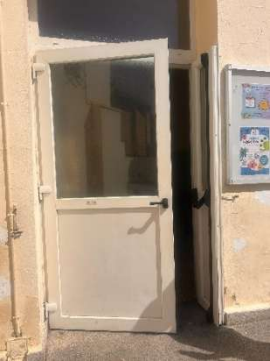
Figura 231 Puerta P5A itinerario 5.
