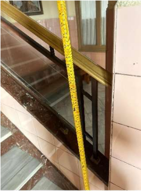
Figura 219 Escalera 3, barrera de protección.
