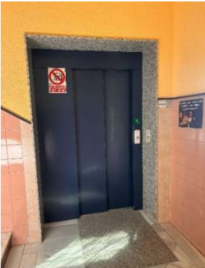
Figura 240 Puerta exterior del ascensor planta 1.
