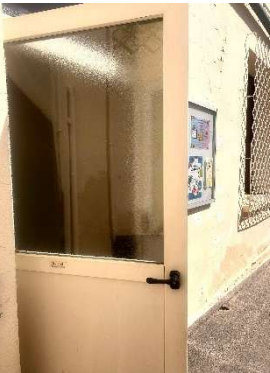
Figura 230 Puerta P5A itinerario 5.
