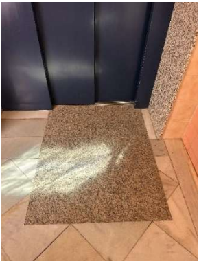
Figura 239 Espacio previo al ascensor. SA. Pavimento táctil.
