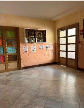
Figura 216 Distribuidor horizontal S4A itinerario 4.
