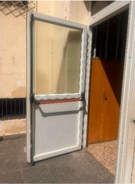
Figura 229 Puerta P5A itinerario 5.
