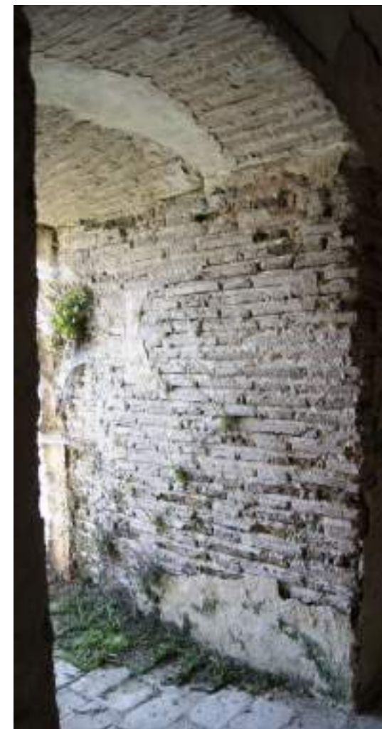
Fig. 102. Humedades ocasionadas por filtraciones de agua desde el adarve, a una de las ventanas situadas al Este del palacio de Castronuevo, Ávila. Imagen del autor.
