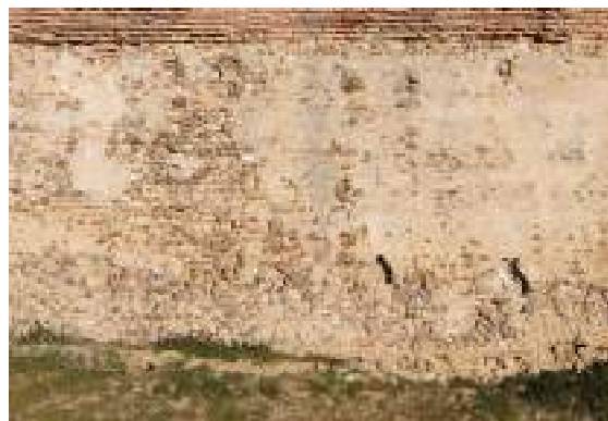
Fig. 104. Erosión atmosférica de los revestimientos de cal de la barrera artillera del castillo de Castronuevo, Ávila. Imagen del autor.
