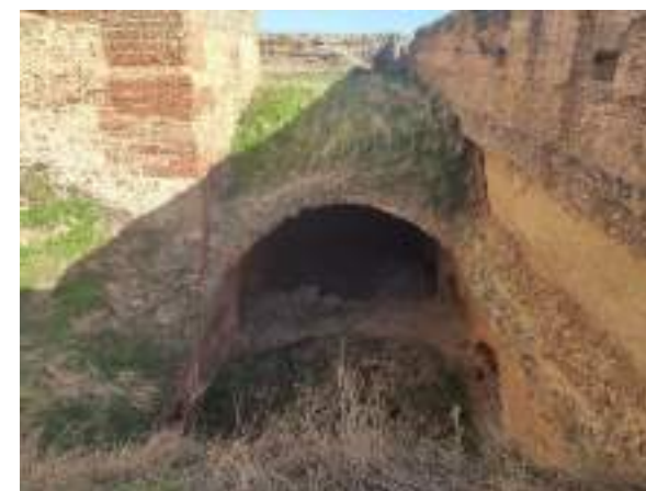
Fig. 61. Tramo arruinado de la liza sur sobre las galerías subterráneas del castillo de Castronuevo, Ávila. Imagen del autor.
