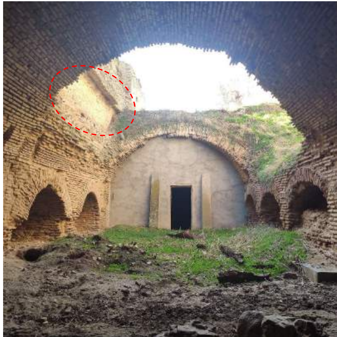
Fig. 79. Tramo colapsado de la bóveda de la galería subterránea Sur de la fortaleza de Castronuevo, Ávila. Imagen del autor.
