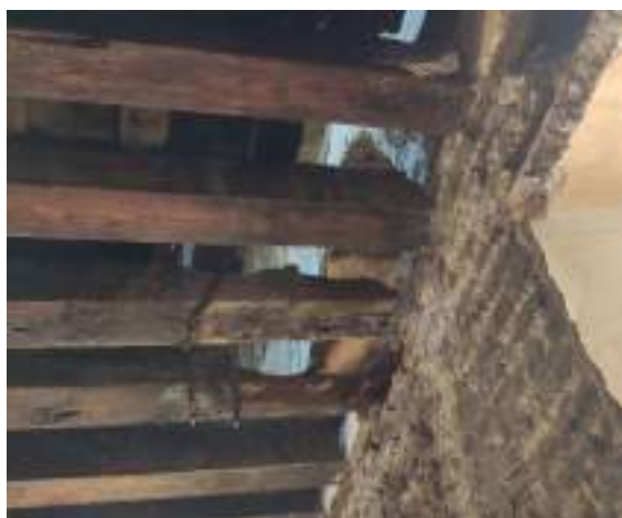
Fig. 93. Vigas descabezadas en su encuentro con el muro, bajo los tablones de madera de la Figura 92 anterior del forjado del palacio de Castronuevo, Ávila. Imagen del autor.
