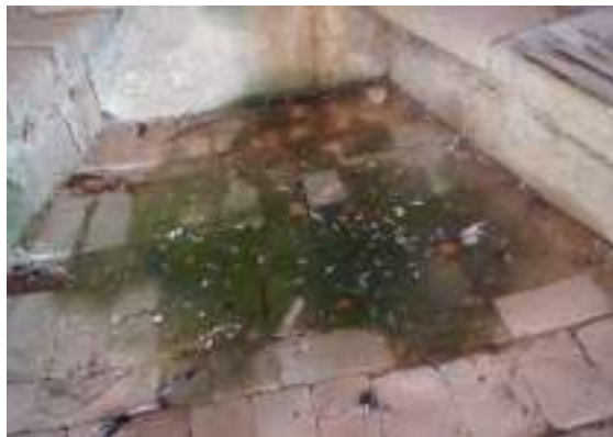
Fig. 103. Tramo de suelo (con presencia de humedades por filtraciones, organismos y erosión mecánica del pavimento de ladrillo) correspondiente a uno de los cortejadores de la planta Primera del palacio de Castronuevo, Ávila. Imagen del autor.
