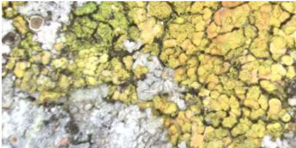
Fig. 122. Microfotografía del ladrillo 01 (líquenes)/ aumento (x 0,75). Imagen del autor.
