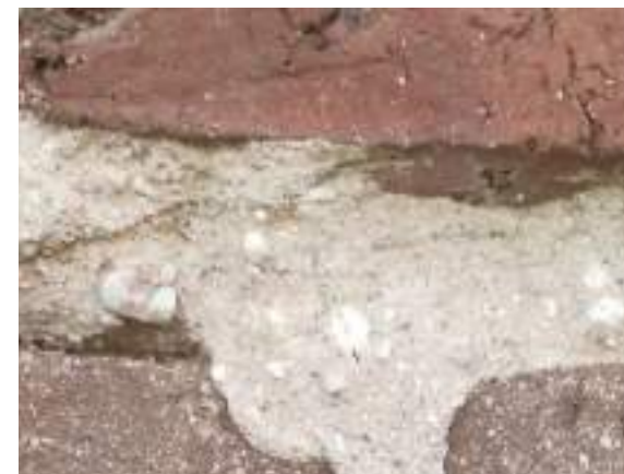
Fig. 68. Mortero de cal de uno de los machones de ladrillo de la torre circular Norte de la fortaleza de Castronuevo, Ávila. Imagen del autor.
