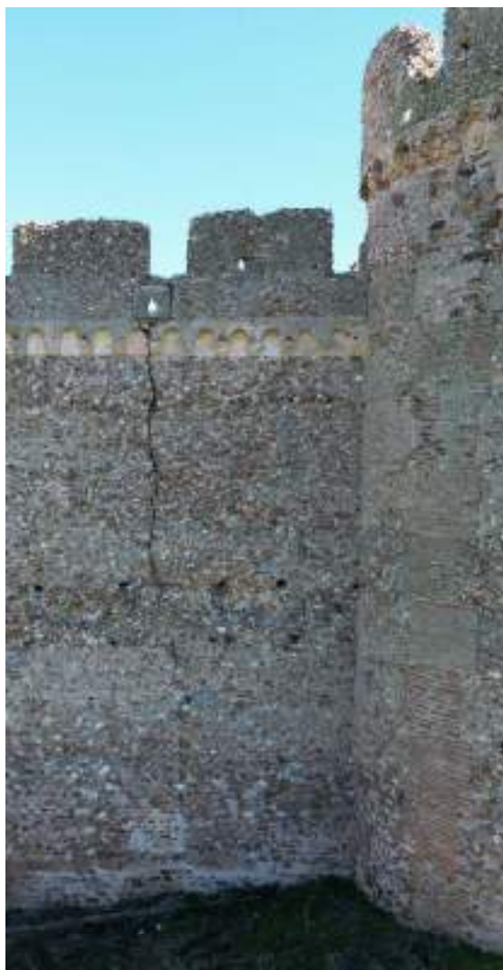
Fig. 106. Grieta en el lienzo Oeste del recinto interior de la fortaleza de Castronuevo, Ávila. Imagen del autor.
