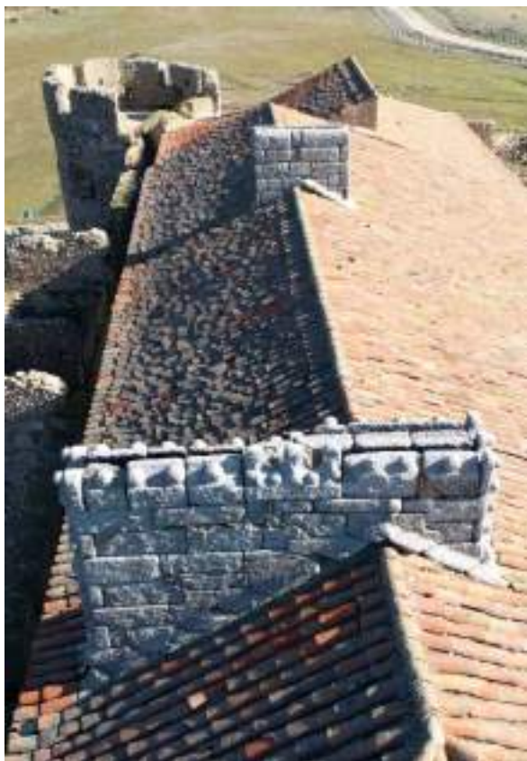
Fig. 07. Chimeneas del Palacio de Castronuevo, Ávila. En la chimenea inferior se aprecia como está rematada con decoración de "bolos", mientras la superior carece de ornamentación. Imagen del autor.
