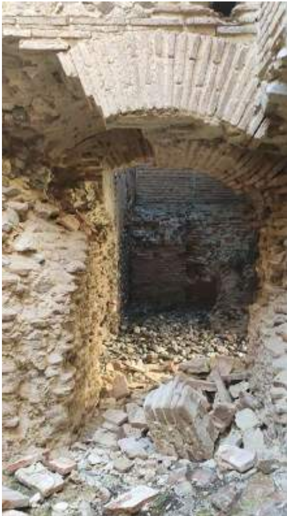
Fig. 62. Interior arruinado de la torre del homenaje del castillo – palacio de Castronuevo, Ávila. Imagen del autor.
