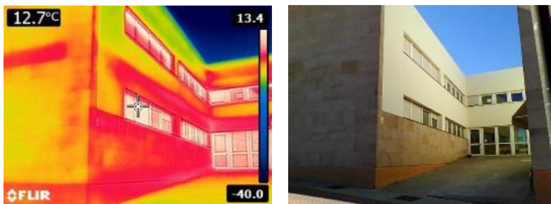
Figura 3.14. Termografía e imagen exterior de la fase 1.
