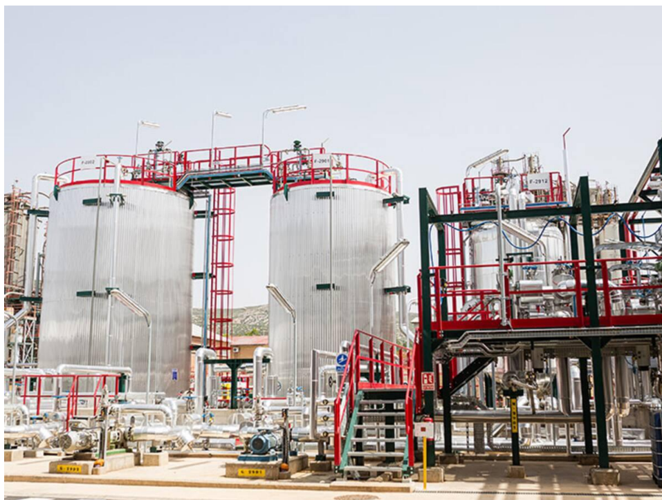
FIG.56: PLANTA DE PUERTOLLANO https://cadenaser.com/castillalamancha/2024/02/02/convirtiendo-un-subproducto-de-pesadilla-en-dulces-suenos-repsol-pone-en-marcha-en-puertollano-su-planta-recpur-ser-ciudad-real/
