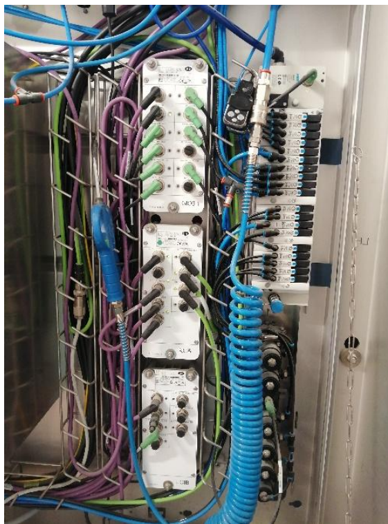
Figura 4.2.14. Paneles de control en el interior del robot.
