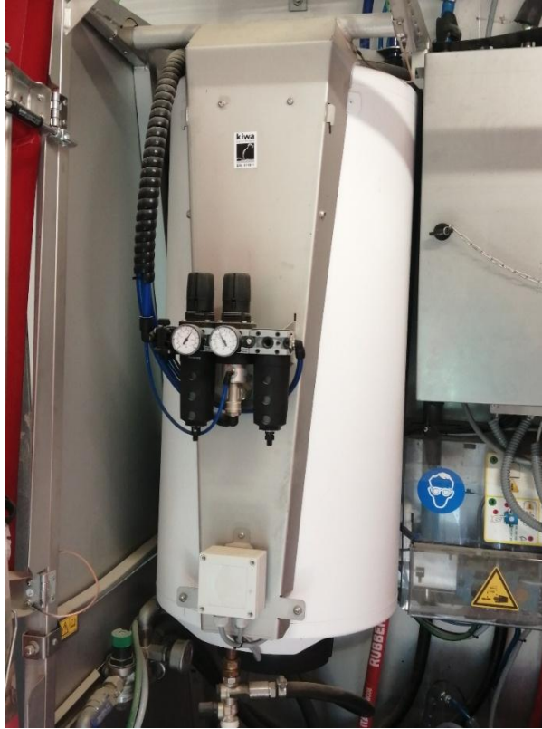
Figura 4.2.16. Vista del interior de la unidad central en la que vemos principalmente la caldera y, a la derecha, el armario central.
