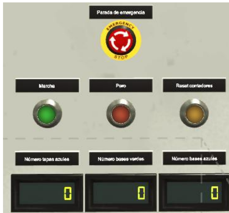
Figura 87. Vista cuadro eléctrico. Escena clasificadora
