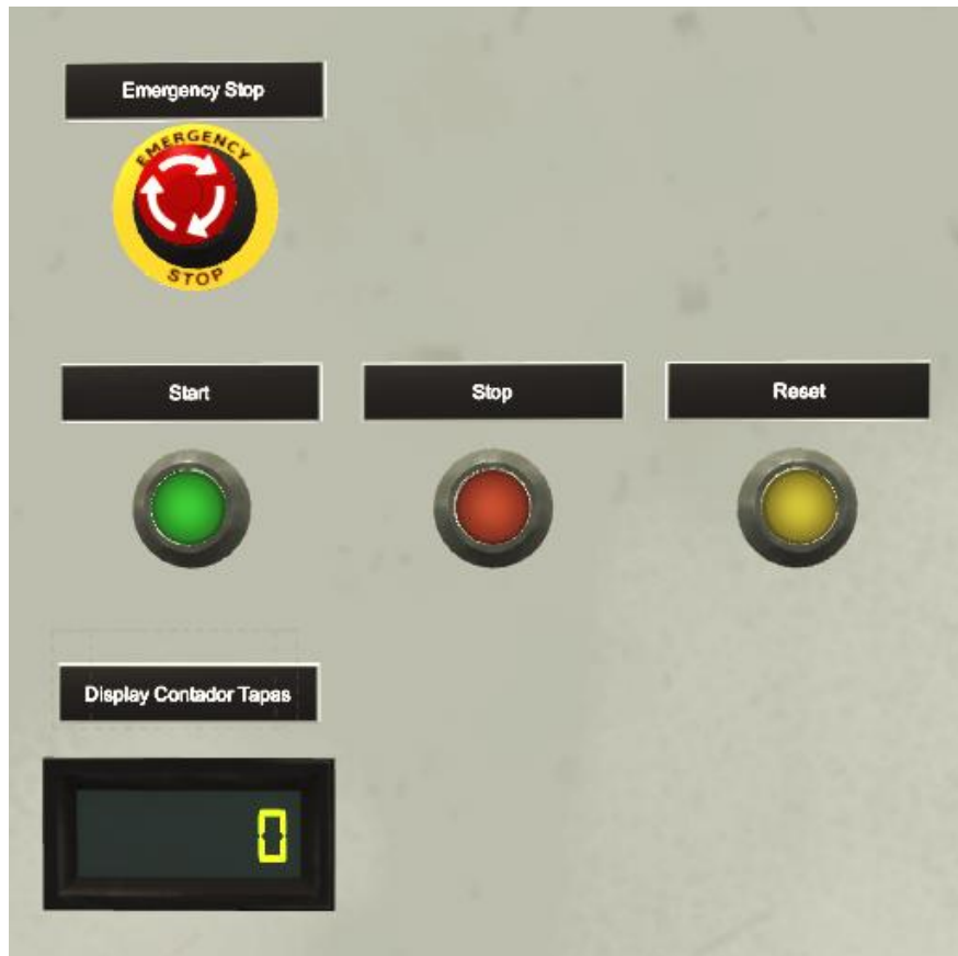
Figura 120. Vista cuadro eléctrico centro tapas. Escena producción en línea
