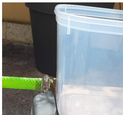
Figura 3-23 Entrada de agua al depósito
