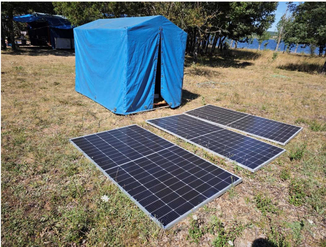
Figura 35. Vista general de la instalación
