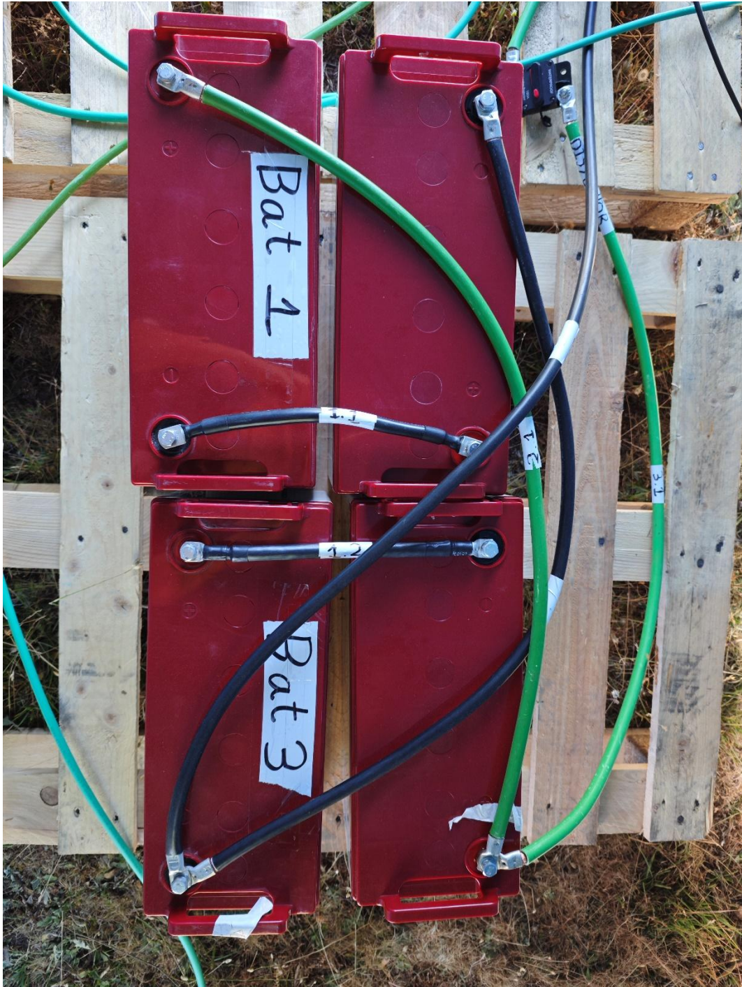
Figura 39. Conexionado de las baterías
