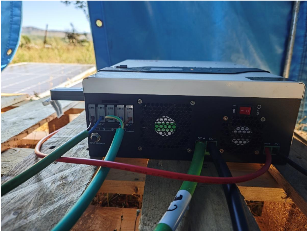
Figura 37. Conexiones del inversor
