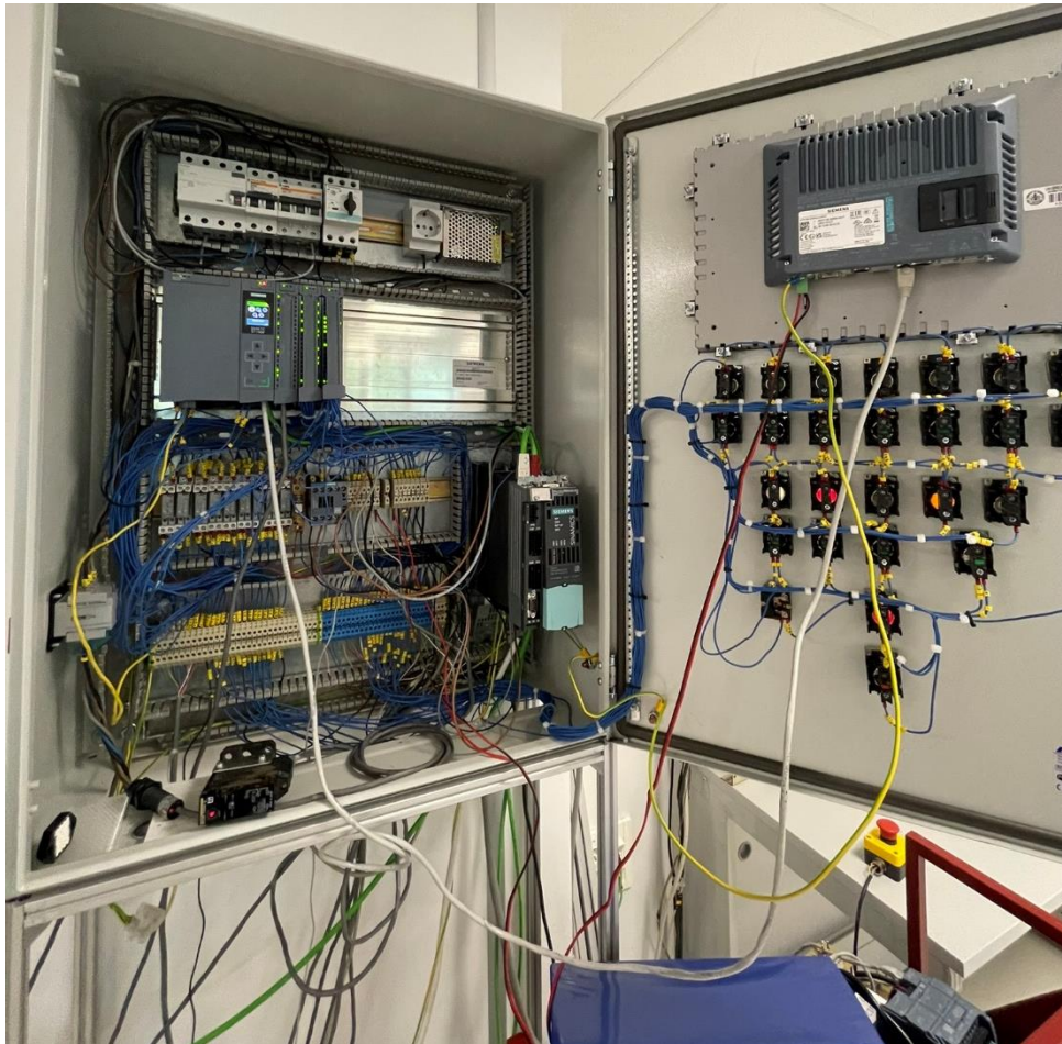
Figura 9. Vista general del armario eléctrico previo a la intervención. (Con el nuevo HMI ya montado)
