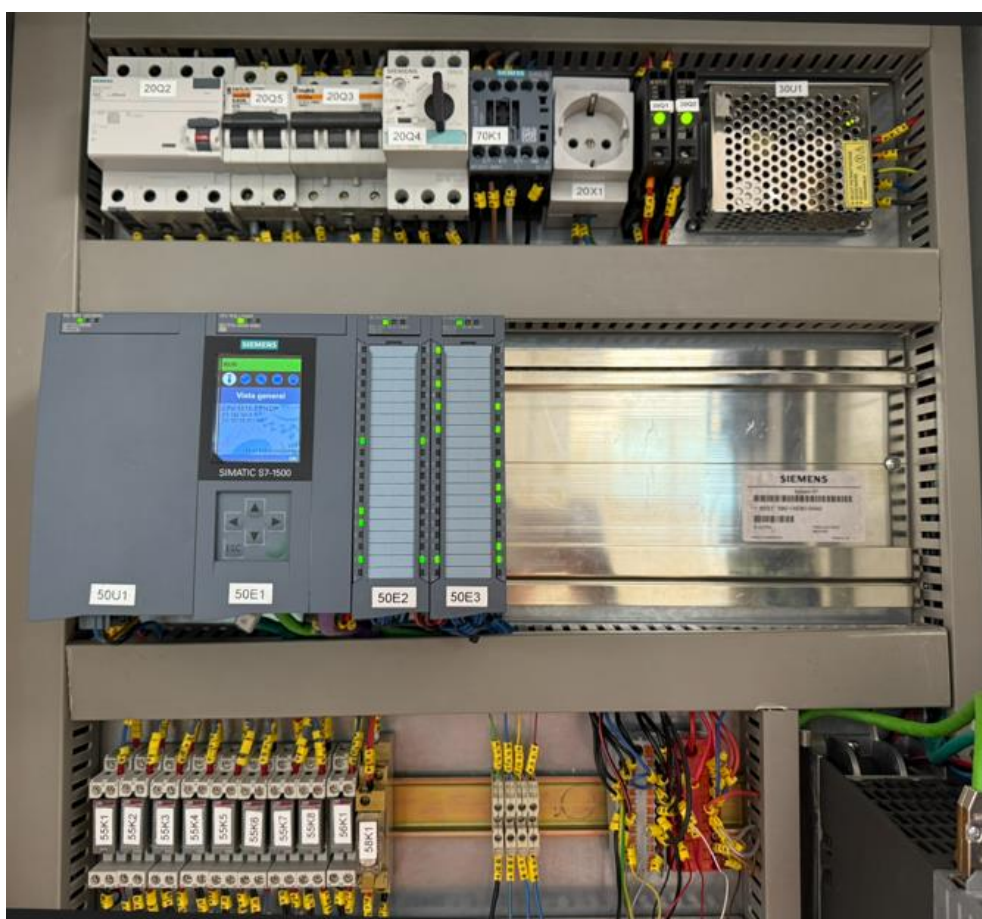
Figura 36. Elementos del armario eléctrico etiquetados.
