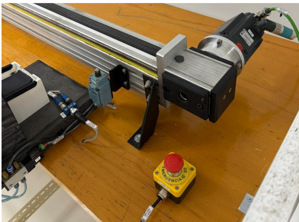
Figura 38. Elementos de campo debidamente etiquetados. Servomotor, seta de emergencia móvil y sensórica del alimentador.
