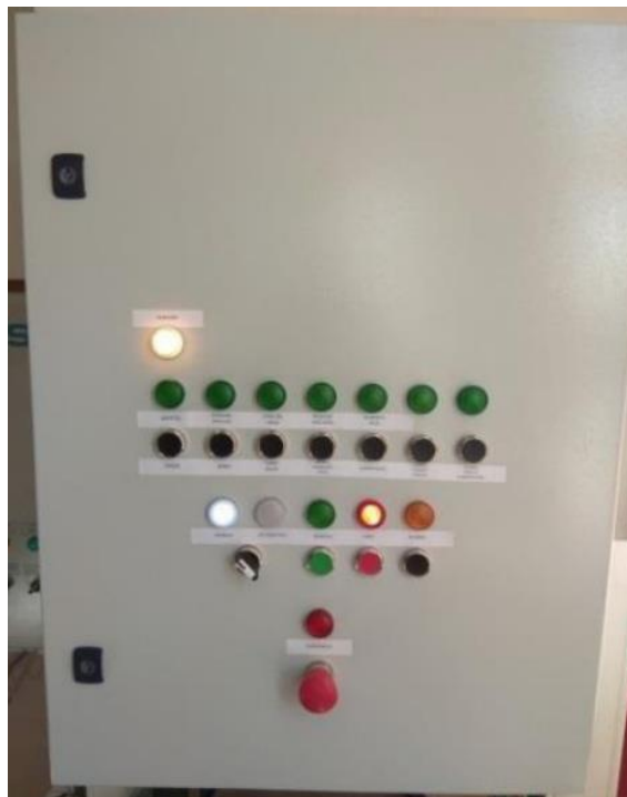
Figura 7. Vista del armario eléctrico previa a la modificación.
