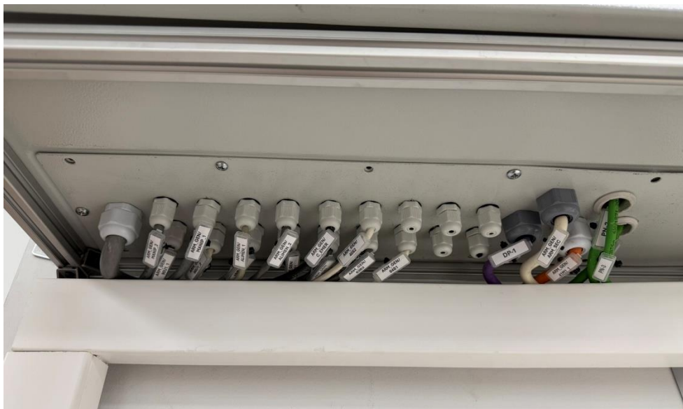
Figura 37. Parte inferior del armario eléctrico. Salida de mangueras.
