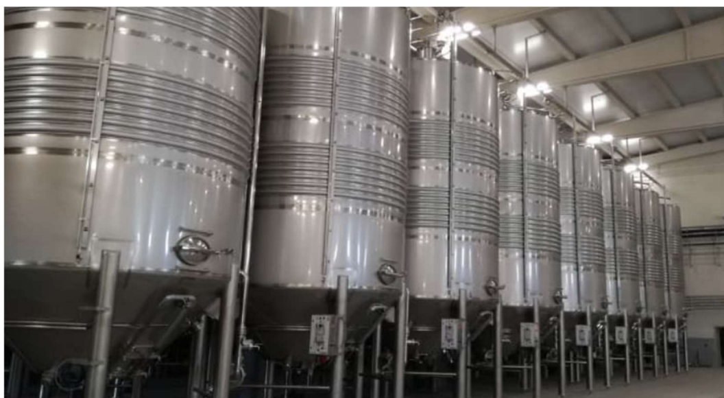
Figura 24: depósitos unidad frigorífica [45]
