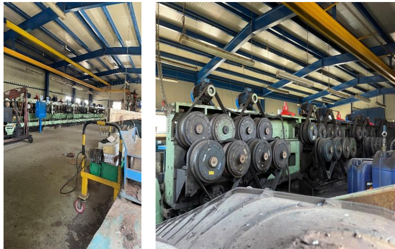
Figura 19 Interior de la nave de regeneración de carril y máquina de reperfilado. Fuente: Propia
