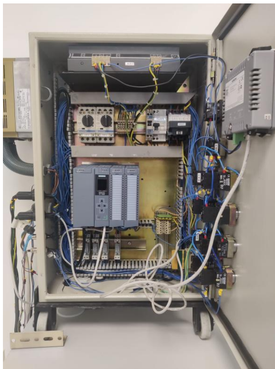
FIGURA 8: SITUACIÓN INICIAL DEL ARMARIO ABIERTO
