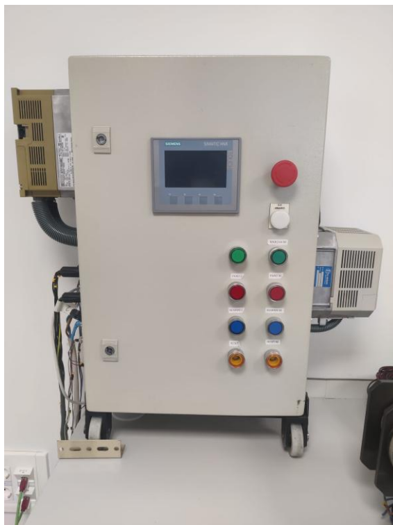
FIGURA 7: SITUACIÓN INICIAL DEL ARMARIO CERRADO
