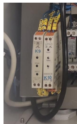
FIGURA 20: AISLADORES ANALÓGICOS INSTALADOS EN EL ARMARIO
