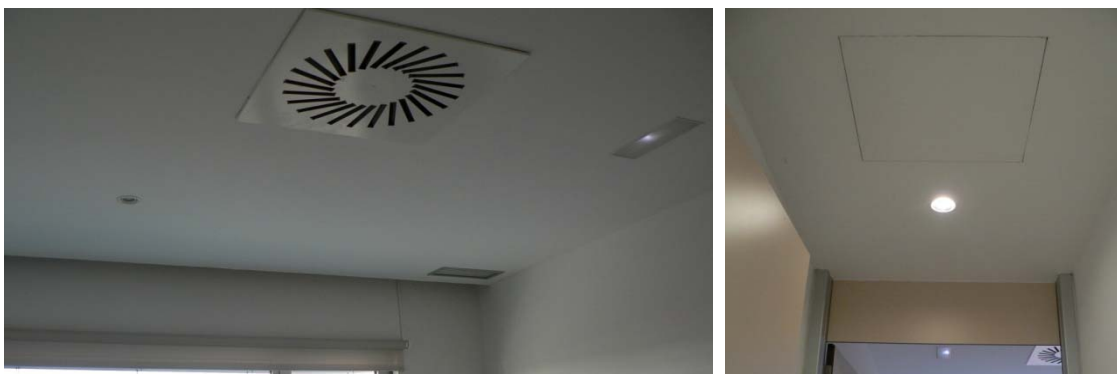
FOTOGRAFÍA B.36. Detalles de ventilación de las habitaciones de TOH del nuevo HURH.
