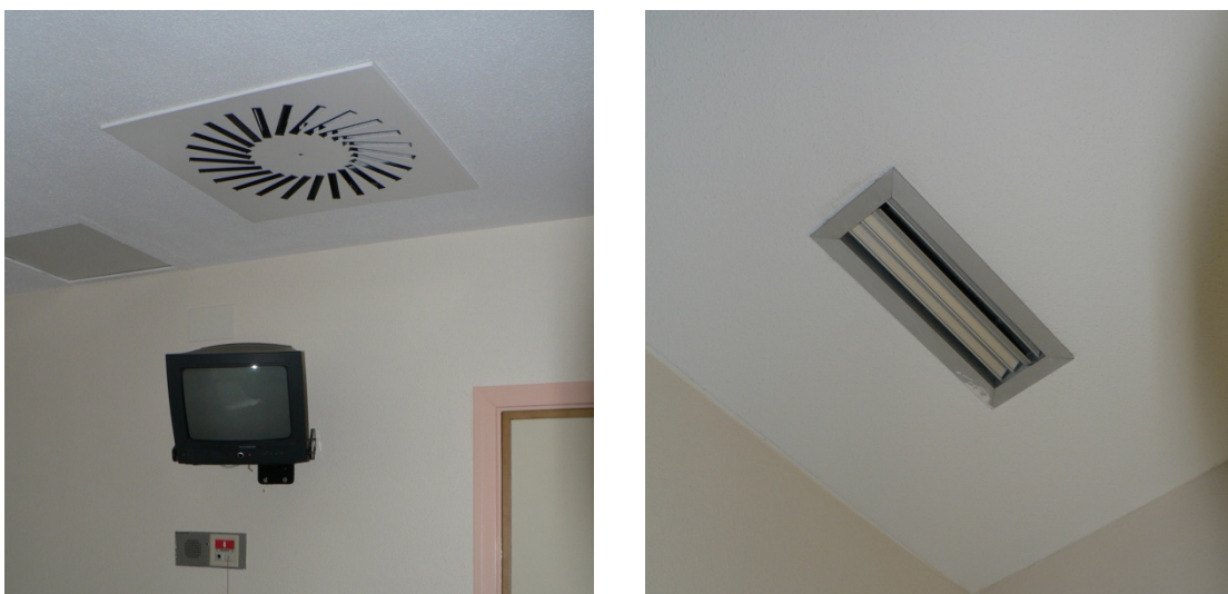
FOTOGRAFÍA A.16. Detalle de la ventilación de las habitaciones TAMO del antiguo HURH.
