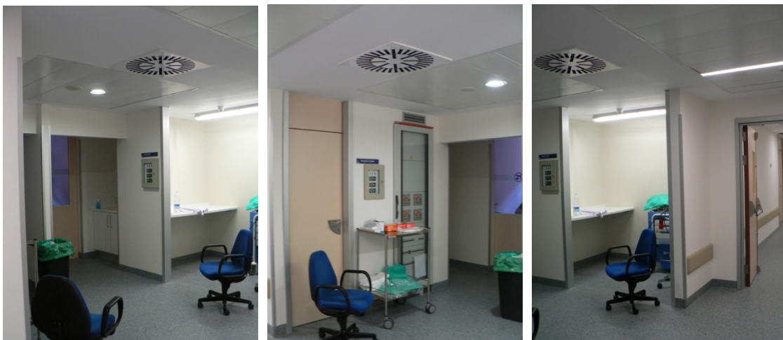
FOTOGRAFÍA B.38. Vistas del control de enfermería de UVI del nuevo HURH.
