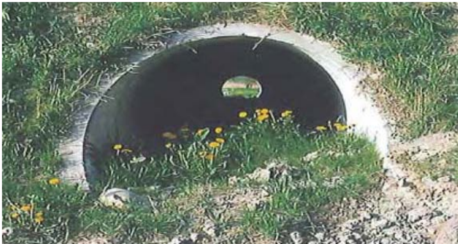
Figura 38.- Tubo de drenaje adaptado. (Foto V. Keller)
