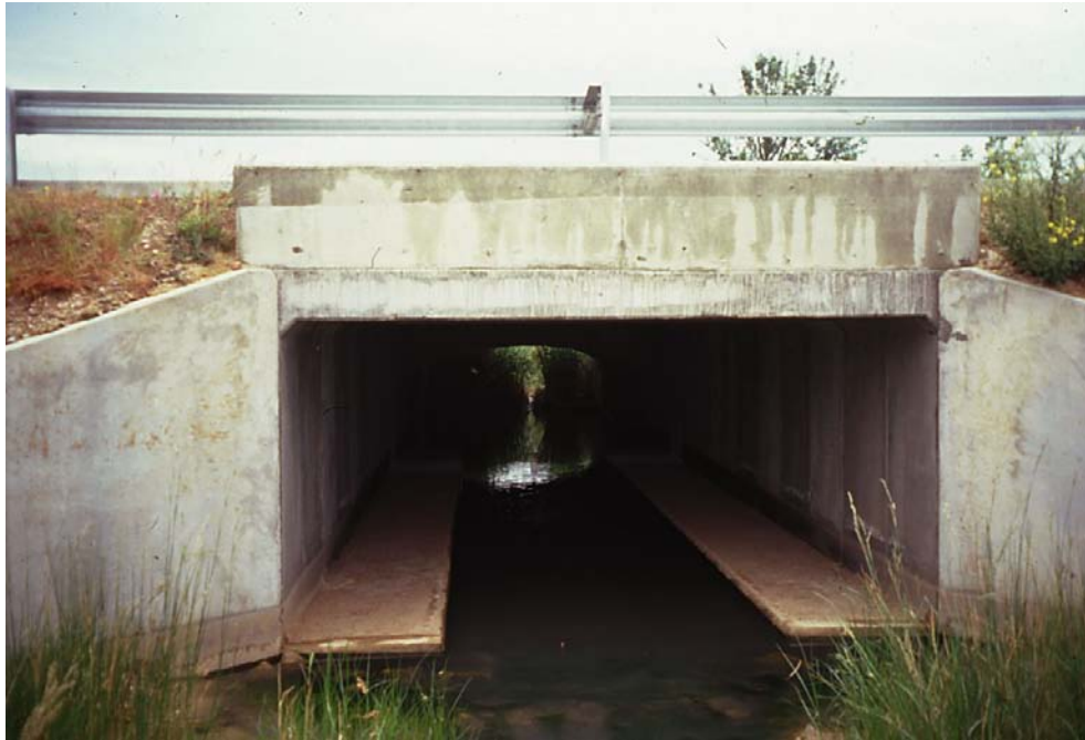
Figura 37.-Paso inferior adaptado en la carretera C-260. (Foto:Minuartia)
