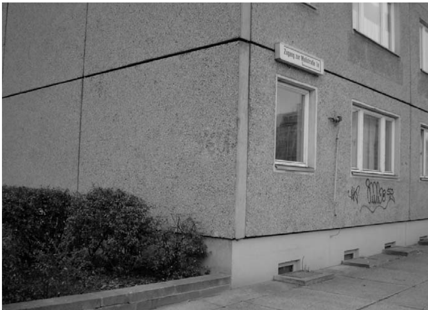
Figura 4. Berlín. Cierre característico de una fachada de viviendas con placas de prefabricación pesada, sin rehabilitar.
