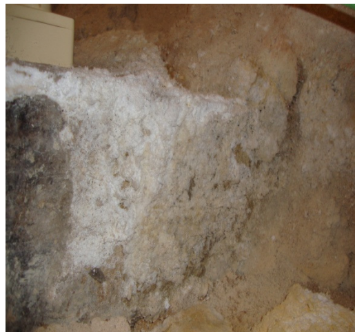
Figura 5.12.- Eflorescencias de la parte externa de la Iglesia.
