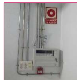
Figura 6: Pulsadores de Alarmas, (ROJOS) y centralita contra incendios general de todo el almacén
