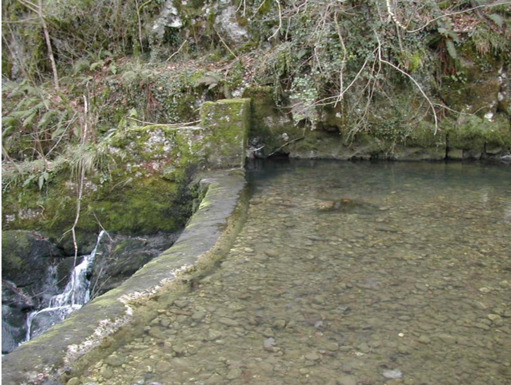
Imagen nº25: Vista de la presa donde se puede apreciar su colmatación.
