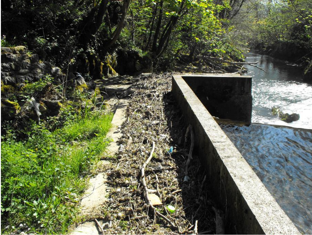
Imagen nº28: vista de la escala salmonera, se puede apreciar el resguardo a la derecha así como los tramex sucios
