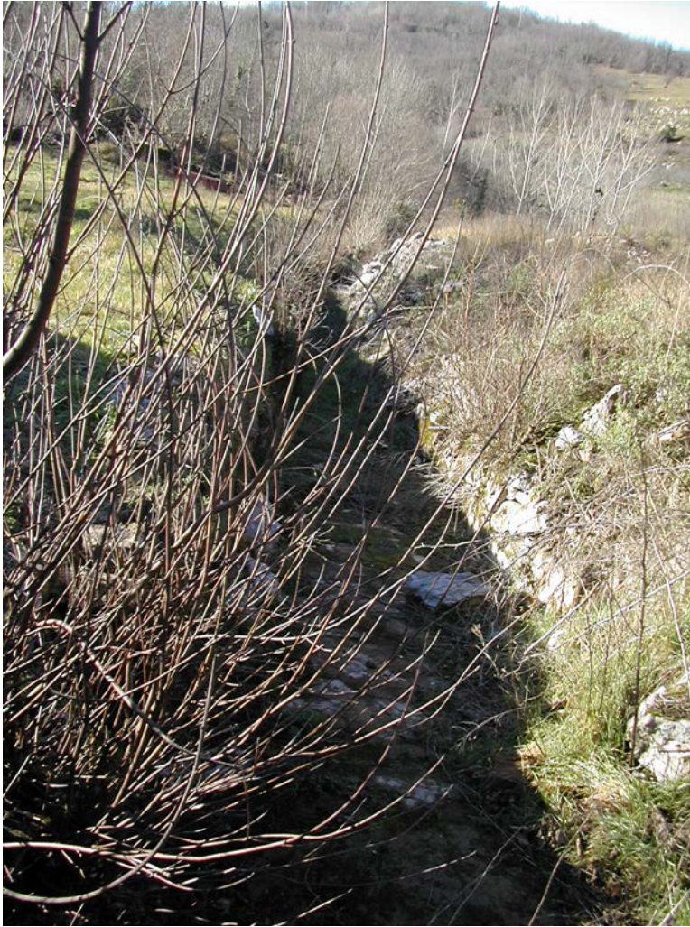
Imagen nº2: Canal en desuso
