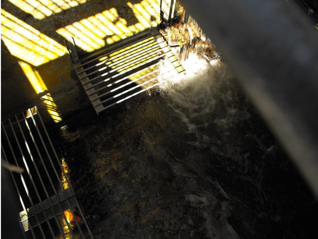
Imagen nº27: Vista de la entrada del agua al capturadero
