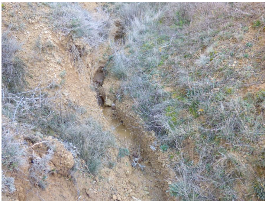
Figura 2.3. Erosión por regueros dentro de la cárcava de estudio.
