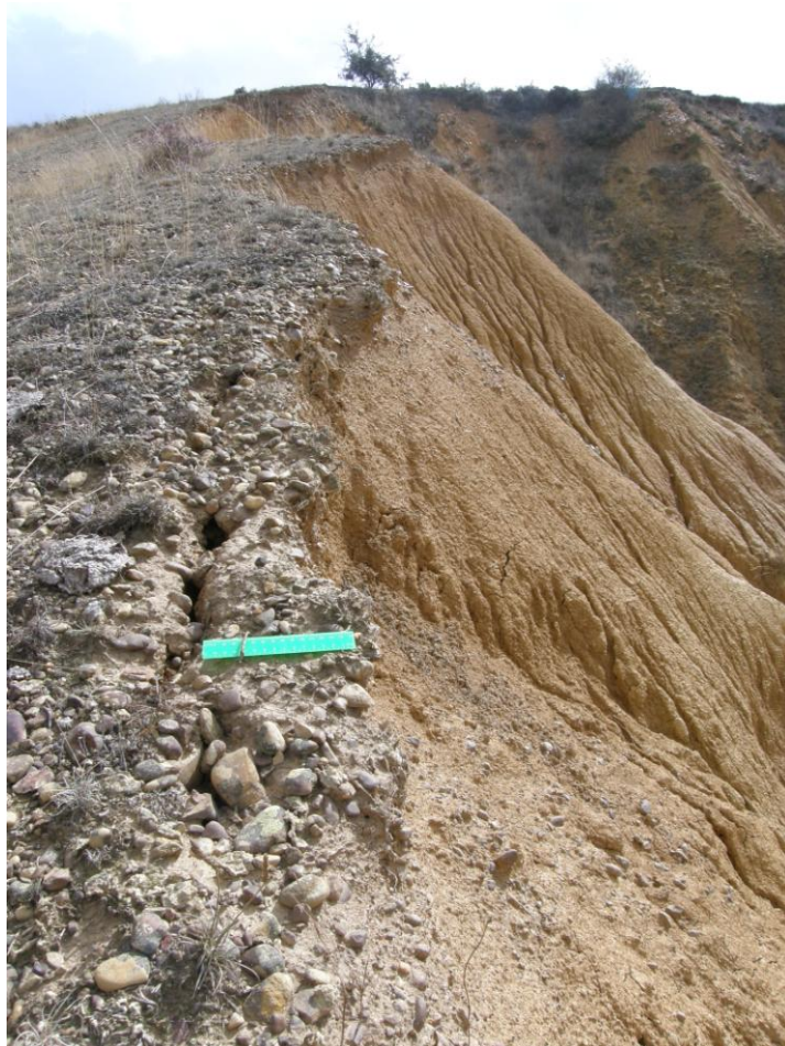
Figura 2.6. Tubificaciones en la cárcava de estudio.
