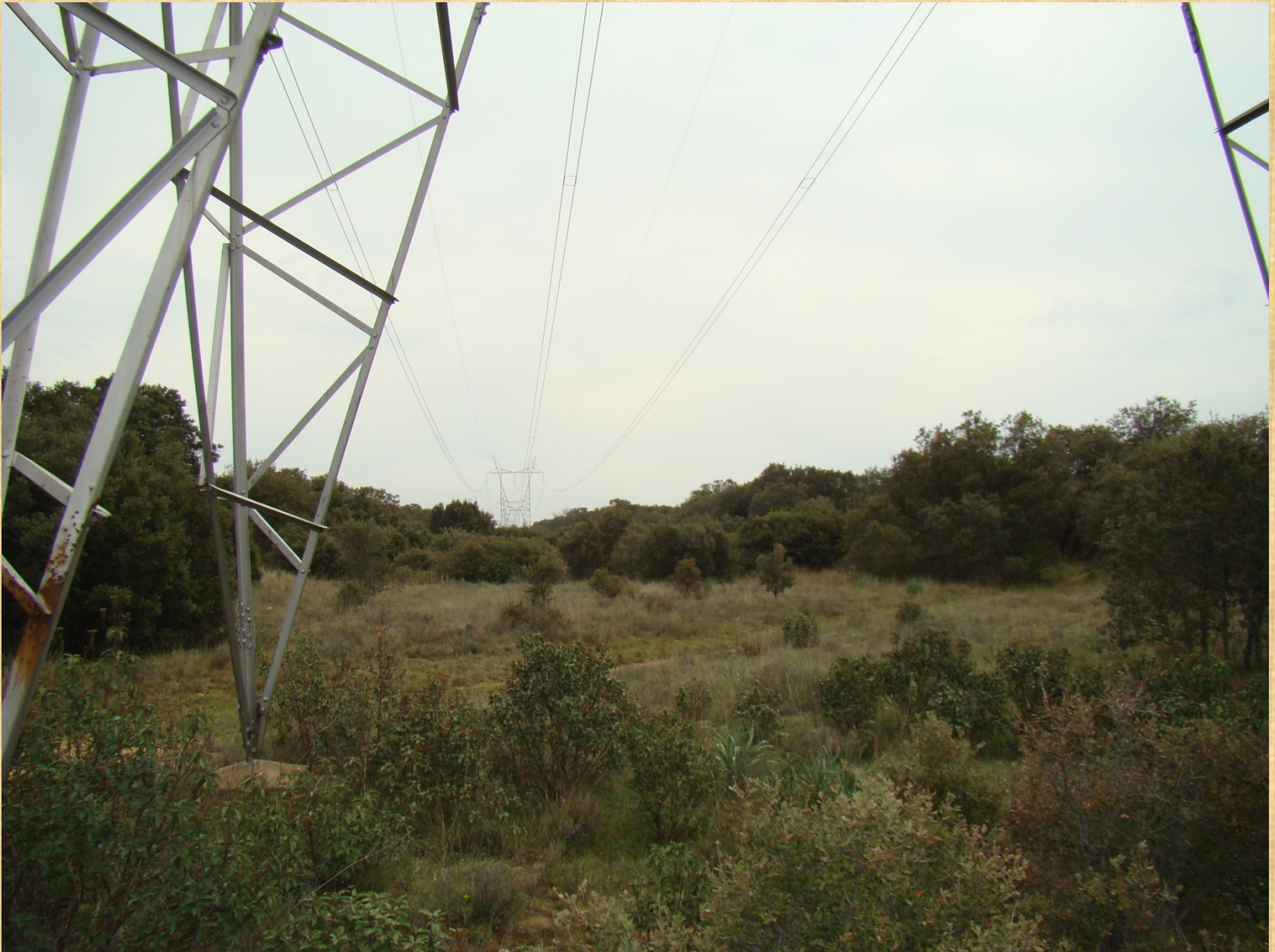
Tendido electrico. Red de alta tensión. 2008 . Foto: E. Delgado
