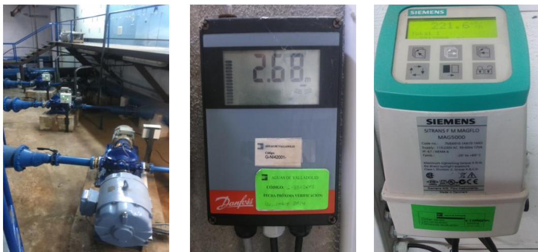
Figura 20. Bombas, Medidor de Nivel y Caudalímetro
