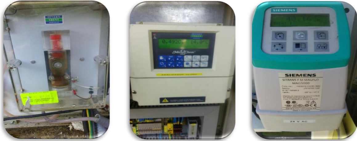
Figura 8. Dosificador, Controlador y Caudalímetro en PCR
